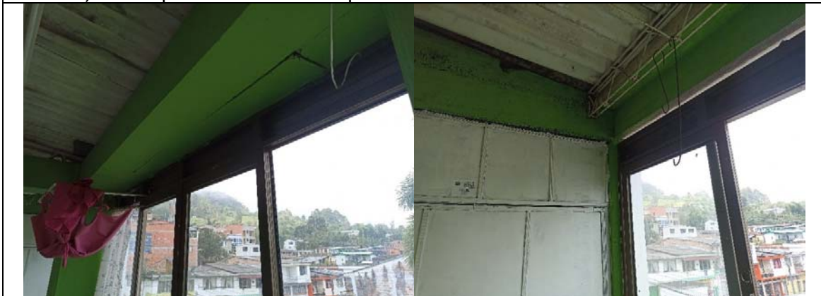
Fotos 5,6 Se requiere impermeabilización de viga canal
