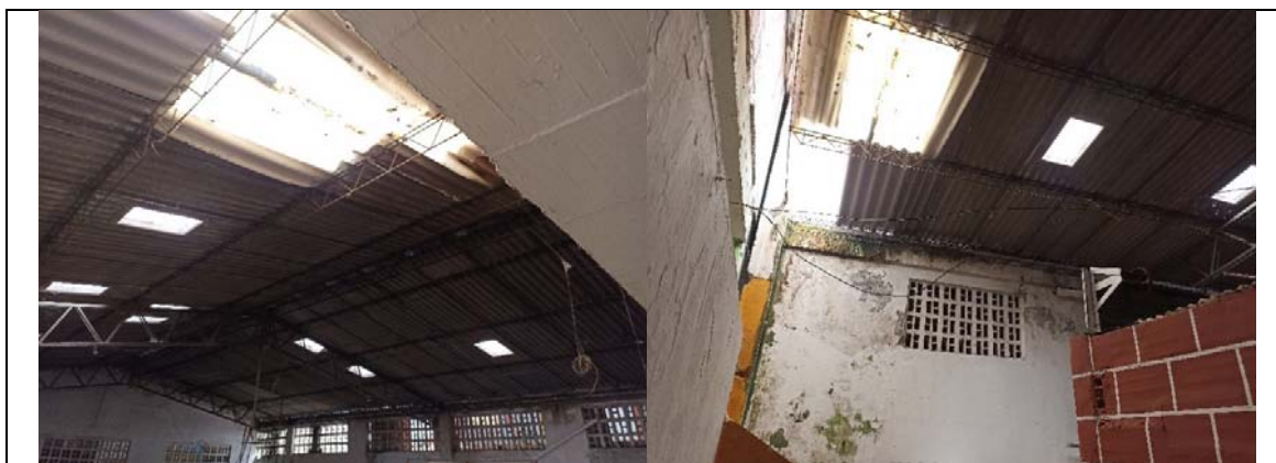
Fotos 1,2 Se requiere recorridos de techo con cambio de tejas en fibro cemento
