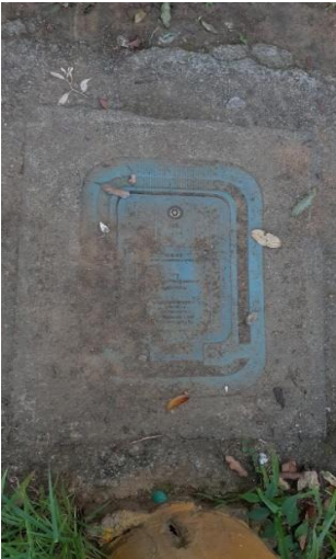
Fotografía 8. Estado actual de la infraestructura, urbanización los Naranjos.
