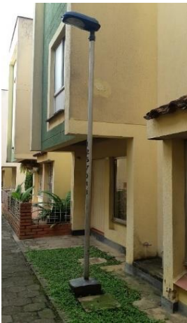
Fotografía 3. Estado actual de la infraestructura, urbanización los Naranjos.
