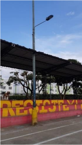
Fotografía 4. Estado actual de la infraestructura, urbanización los Naranjos.
