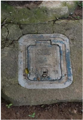
Fotografía 9. Estado actual de la infraestructura, urbanización los Naranjos. Fuente: elaboración propia.
