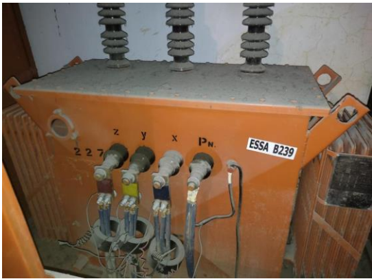
Fotografía 10. Estado actual del transformador existente, urbanización los Naranjos. Fuente: elaboración propia.
