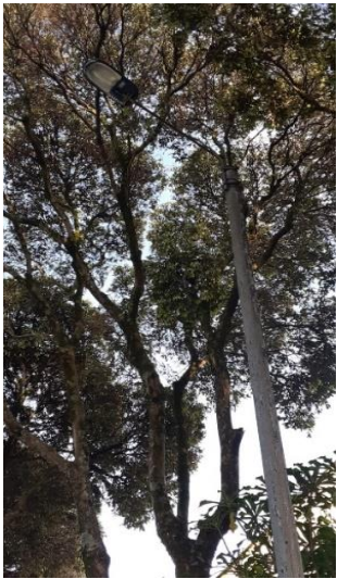
Fotografía 7. Estado actual de la infraestructura, urbanización los Naranjos.
