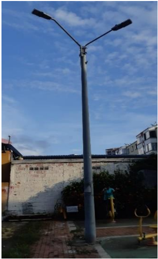
Fotografía 5. Estado actual de la infraestructura, urbanización los Naranjos.
