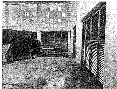
El contratista dejó desaguando al interior del comedor una bajante, causando deterioro al interior del bloque
