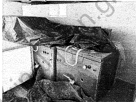
Los equipos de cocina no están debidamente protegidos para su entrega
