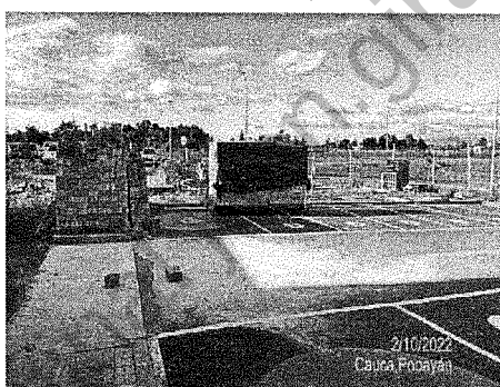
Al lado del bloque A existe otra planta que iba a ser destinada para el bloque A. De igual forma hay materiales y no se ha liberado el espacio de parqueadero que ya podría haber sido entregado.
