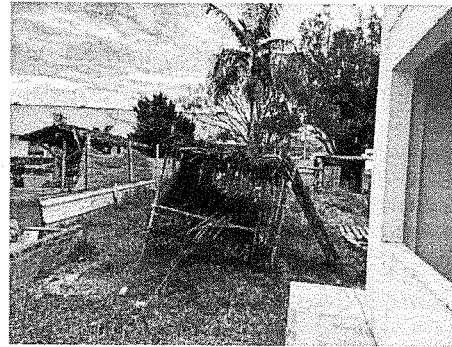
El contratista no ha retirado materiales sobrantes del frente de bienestar y paisajismo
