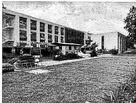
El contratista ocupa espacios del comando con campamentos, escombros y materiales
