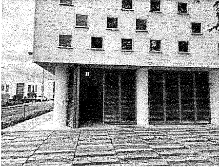
El frente de comedor no está debidamente cerrado no ha sido entregado por el contratista o la interventoría
