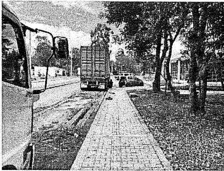
El contratista finalmente dispuso, después de nueve (9) meses, el movimiento de un contenedor de su propiedad en donde almacenaba materiales. El contenedor obstaculizaba la vía principal
