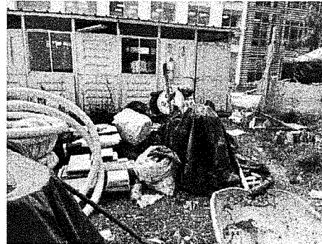
El contratista ocupa espacios del comando con campamentos, escombros y materiales
