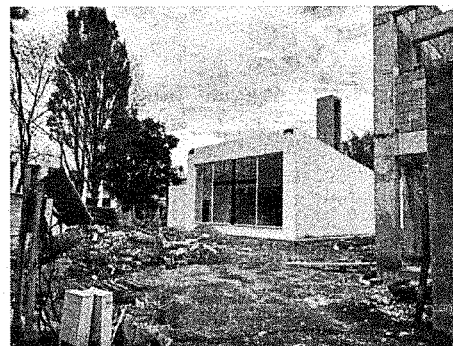
En el frente de auditorio y capilla no estaba dispuesto el cerramiento ni se había recogido escombros y materiales
