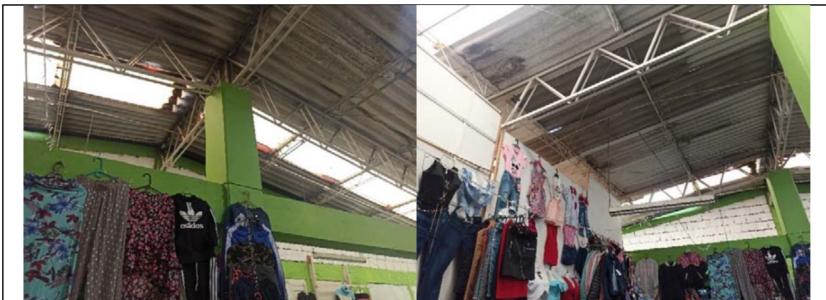
Fotos 7,8 Se requiere cielo raso en PVC
