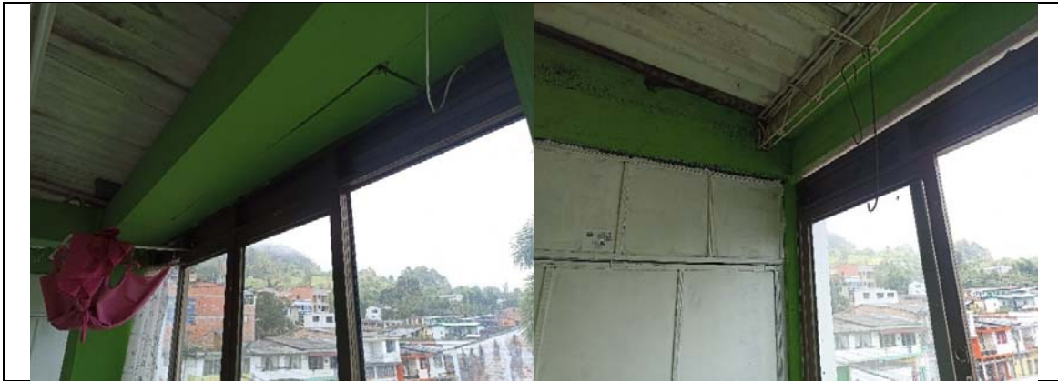
Fotos 5,6 Se requiere impermeabilización de viga canal
