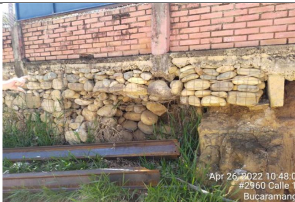
Fotografía 3: Estado actual cimentación cerramiento, vista interna (Fuente propia)
