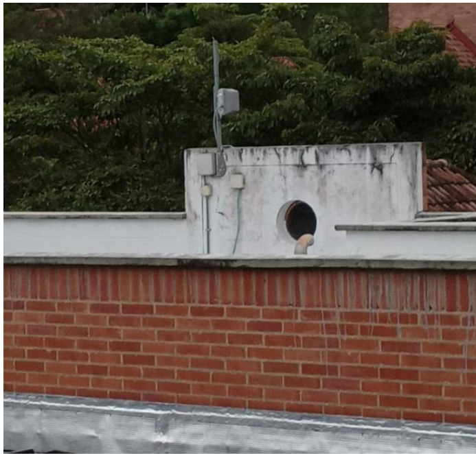
Estado inicial alfajías bloque administrativo, zona frontal al acceso.
