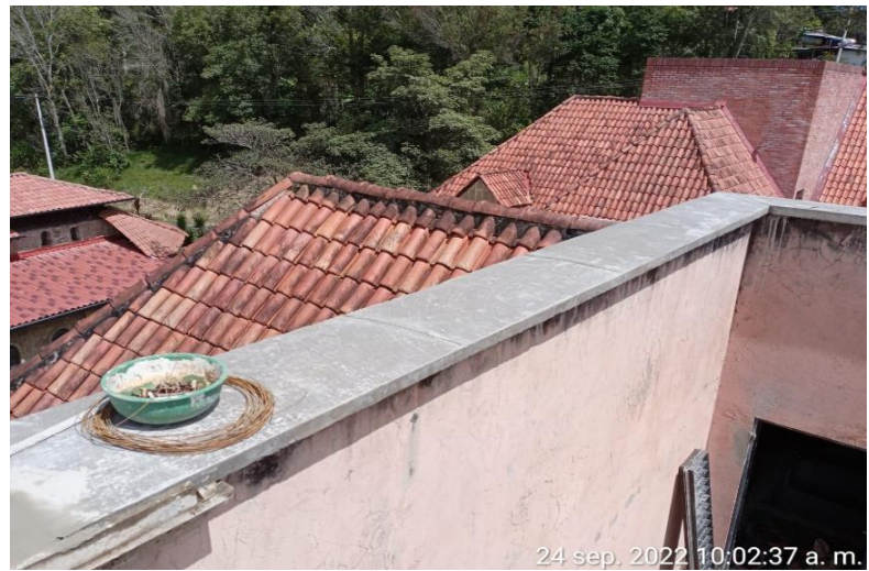
Dilataciones en alfajia bloque alojamientos B
