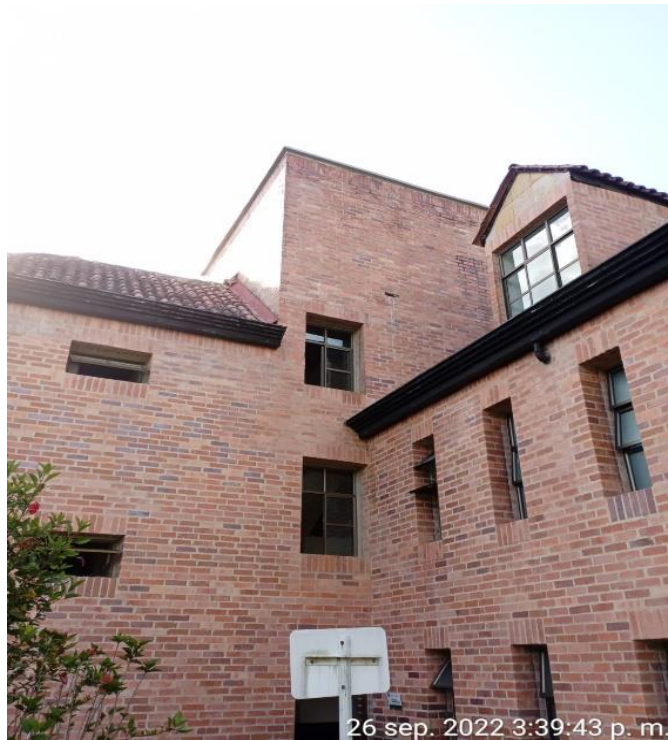
Estado final alfajia en el bloque alojamientos B
