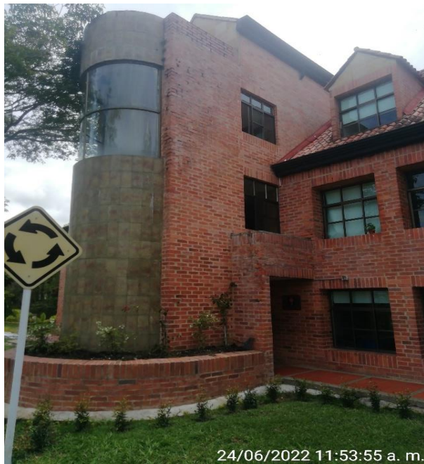
Estado inicial alfajia en punto fijo bloque academino N°2
