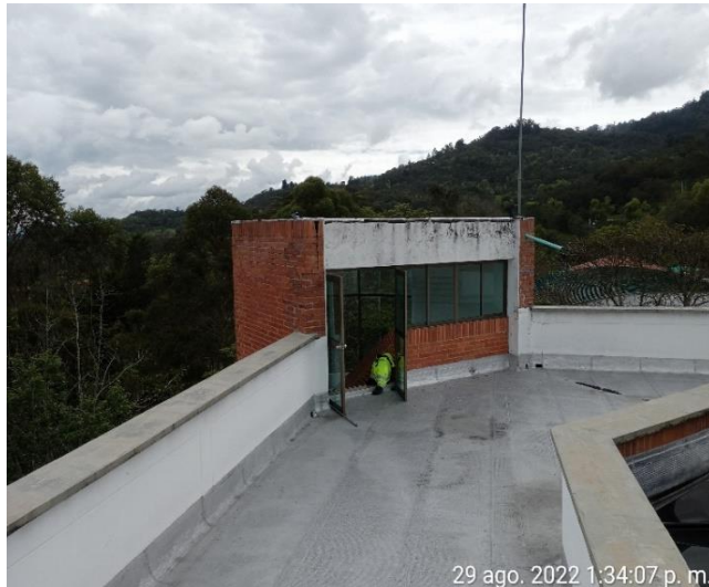
Estado inicial alfajías bloque administrativo, zona de acceso.
