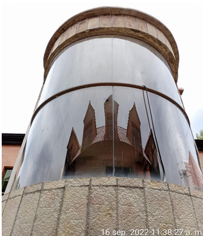
Estado final alfajía en punto fijo Área académica
