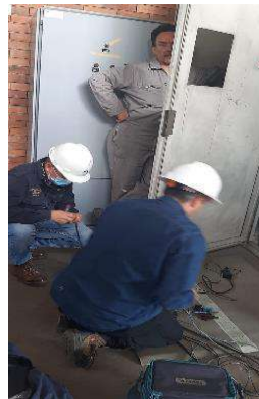
Instalación equipo de medición Subestación eléctrica Torre Oriental
