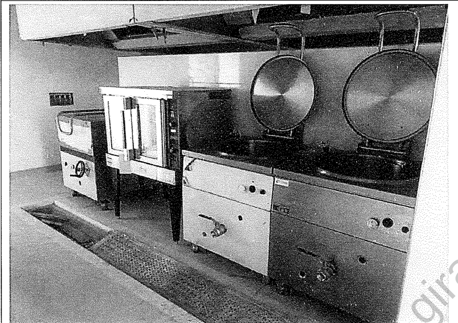
FRENTE COMEDOR – EQUIPOS DE COCINA
