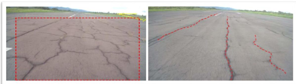
Ilustración 4 Estado actual Pista
