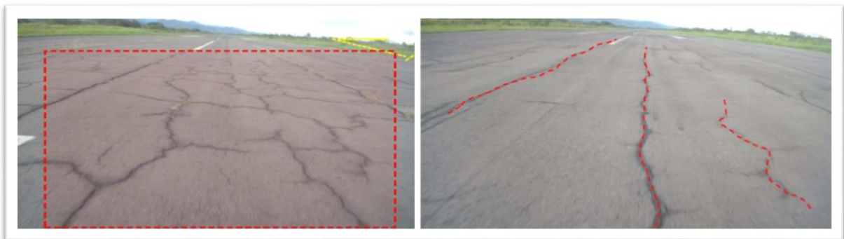
Ilustración 4 Estado actual Pista
