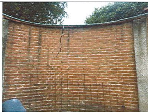
Muro a reparar
