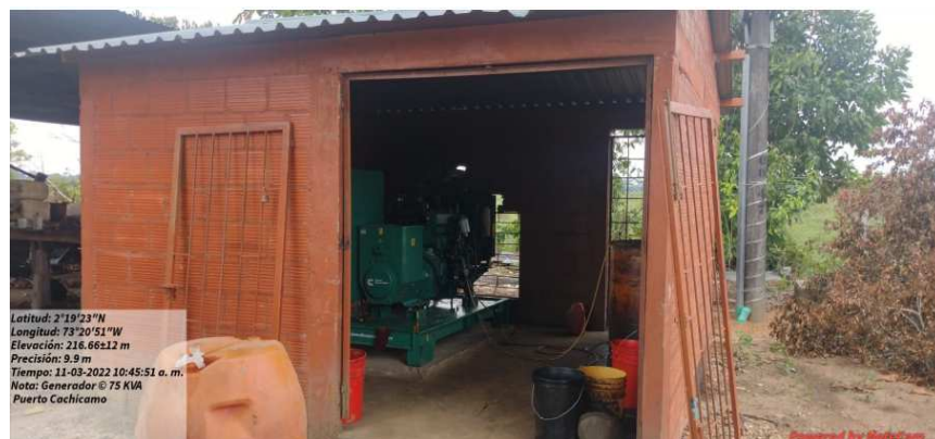
Ilustración 20. Central de generación Puerto Cachicamo.
