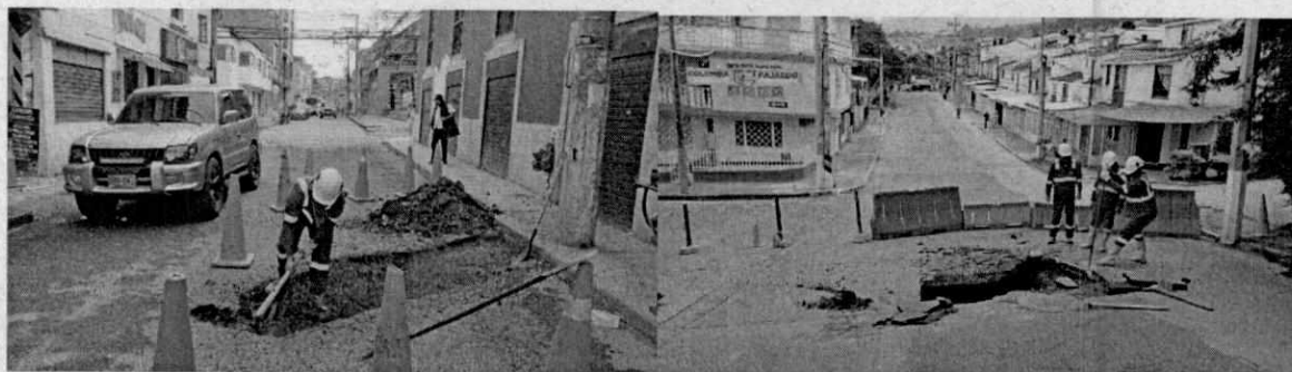
Figura 4. Vías afectadas por colapso súbito de la red de alcantarillado
