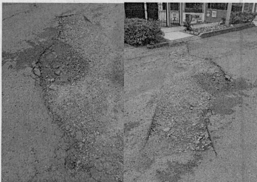
Figura 3. Estructura de pavimento afectada por juntas y cambio de módulos
