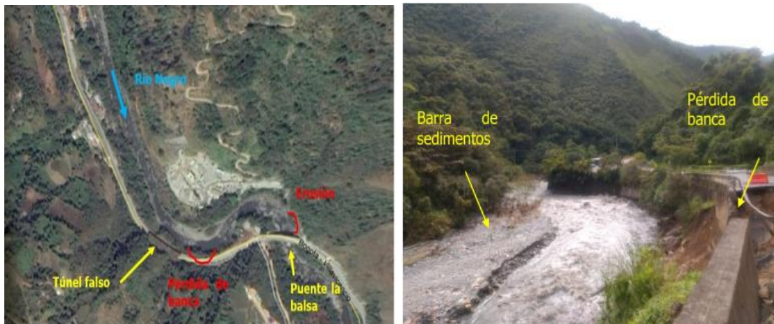
Figura 3 y 4. Localización del sector PR48+060 – pérdida de Banca Fuente: Interventoría Metroandina SAS
