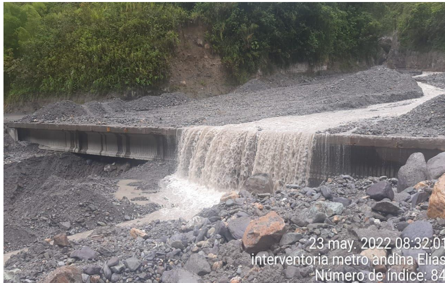
Figura 6. Localización del Puente afectado por las avalanchas de la Quebrada Estaquecá Fuente: Interventoría Metroandina SAS
