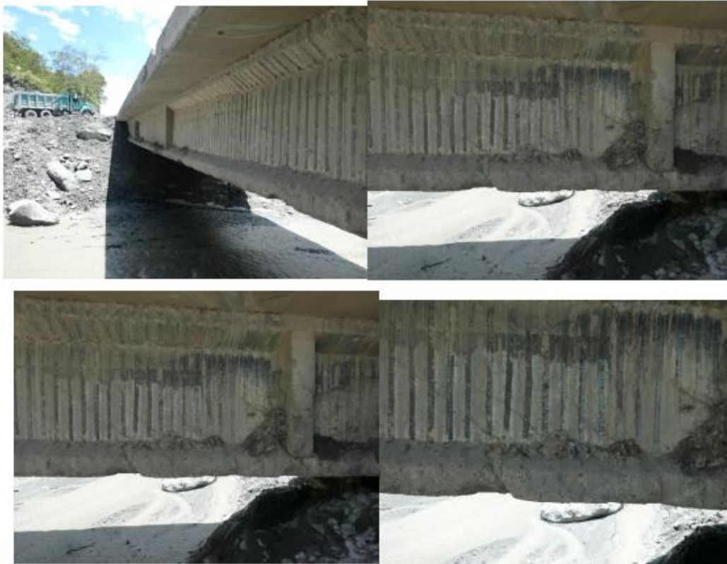
Figura 7. Localización del Puente afectado por las avalanchas de la Quebrada Estaquecá – Afectación de las Vigas Fuente: Interventoría Metroandina SAS
