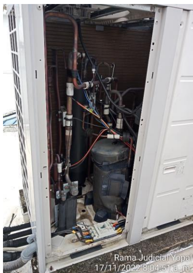
IMAGEN 5 PROTECCIÓN ELÉCTRICA AL INTERIOR DE LA UNIDAD EXTERIOR
