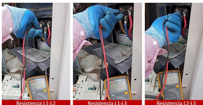
IMAGEN 9 MEDICIÓN DE RESISTENCIA EN BOBINAS DE COMPRESOR INVERTER 1
