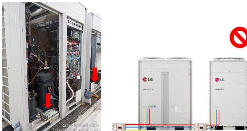
IMAGEN 6 INSTALACIÓN ACTUAL DE PROTECCIONES Y CABLEADO ELÉCTRICO
