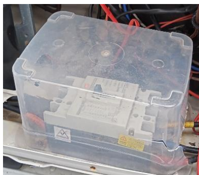
IMAGEN 4 PROTECCIÓN ELÉCTRICA AL INTERIOR DE LA UNIDAD EXTERIOR
