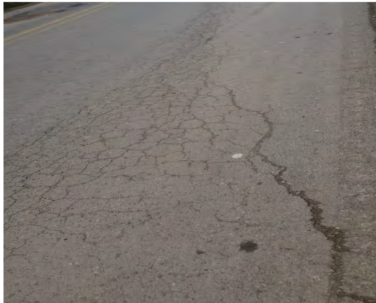
Foto 8 – PR1+000 Estado del pavimento existente
