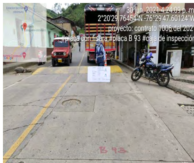
Foto 14 –PR25+500 Pavimento hidráulico existente- PLACA B12- B55-B93
