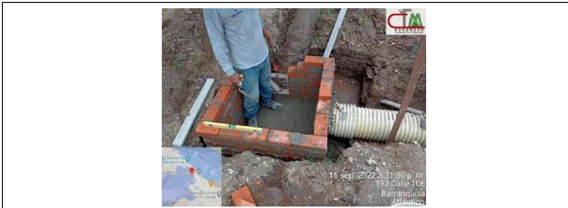
IMAGEN 13 Registros de aguas lluvias No 32 y 33.
