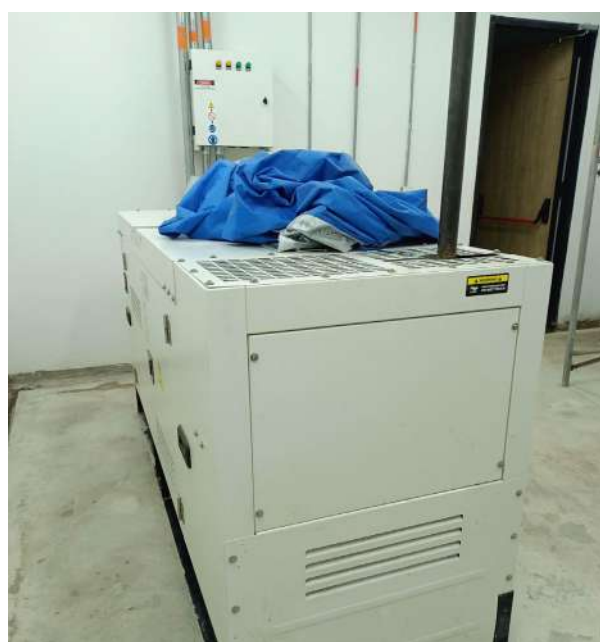
Falta de conexión a tablero eléctrico y transferencia
