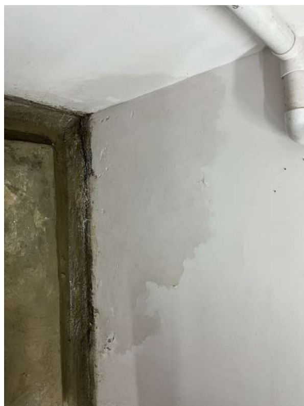
Manchas de humedad que evidencian el mal funcionamiento de los filtros perimetrales del subsuelo
