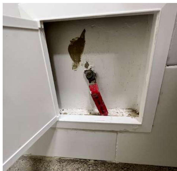
Llave de uno de los baños que no cierra apropiadamente.
