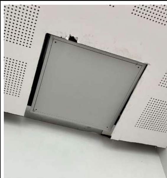
Cielorraso del primer piso perforado e intervenido inapropiadamente, sin reparar.
