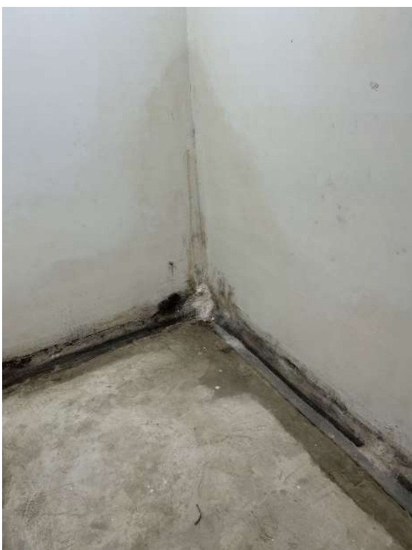
Presencia de humedades, sales y filtraciones de agua y olores a través de los muros del sótano.
