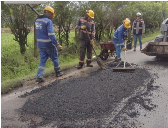
Tapahuecos entre el PR21+0300 y el PR29+0700 (28/10/22)
