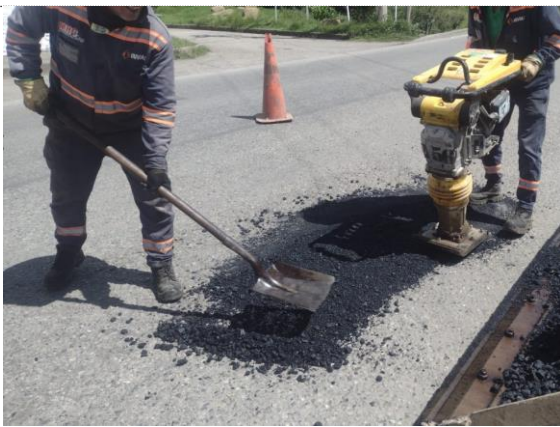
Tapahuecos entre el PR8+0600 y el PR21+0050 (31/10/22)
