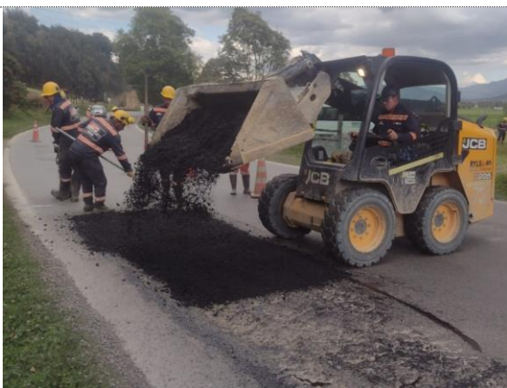
Tapahuecos entre el PR8+0600 y el PR21+0050 (31/10/22)
