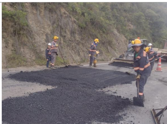
Tapahuecos entre el PR8+0600 y el PR21+0050 (31/10/22)
