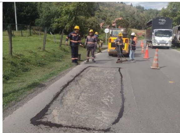
Tapahuecos entre el PR8+0600 y el PR21+0050 (31/10/22)
