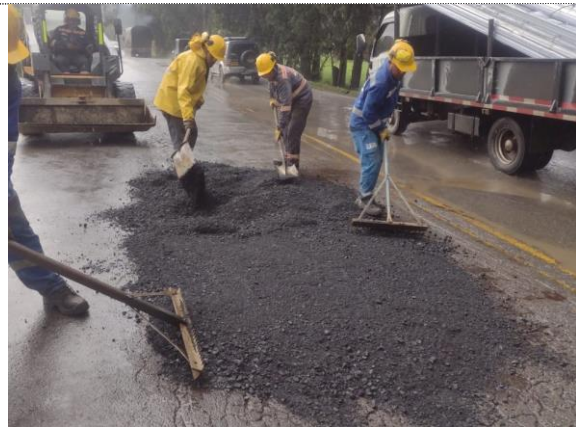
Tapahuecos entre el PR21+0300 y el PR29+0700 (28/10/22)
