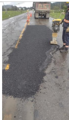
Tapahuecos entre el PR21+0300 y el PR29+0700 (28/10/22)
