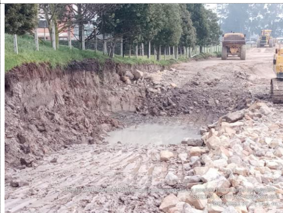
Conectante sur K0+310 – K0+320 excavación de fallo a nivel de subrasante (13/09/22)
