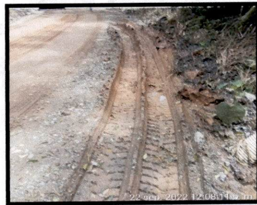
Se observa alto grado de humedad, tramo 2
