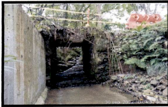
Km 1+0590 tramo 1, obra inconclusa por anterior contratista
