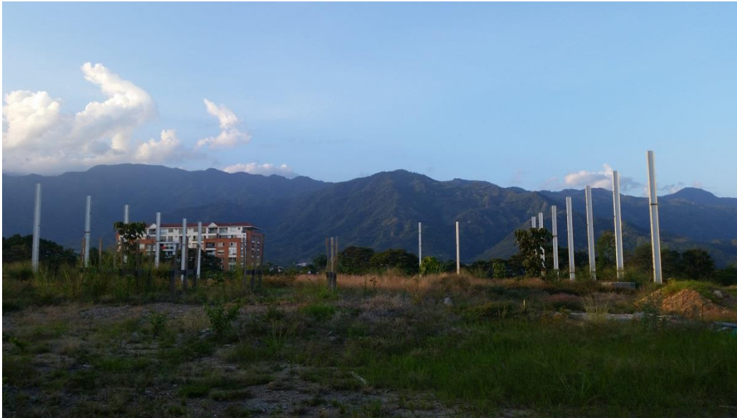
Fotografía 1. Estado actual del Coliseo Mayor.
