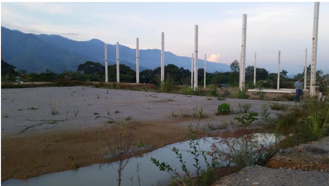
Fotografía 2. Estado actual del Coliseo Mayor.
