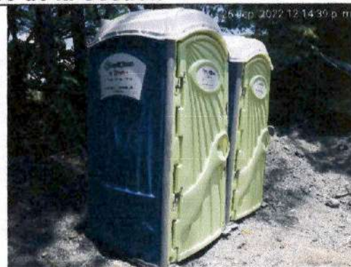
Ilustración 7. Unidades sanitarias Km 5+400
