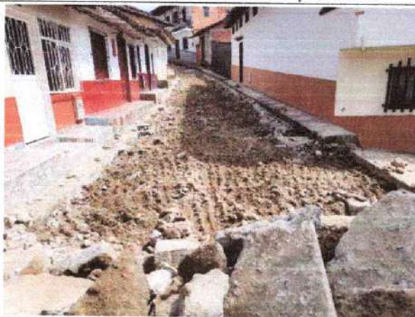
Foto 13. Acabado lleno de brecha
