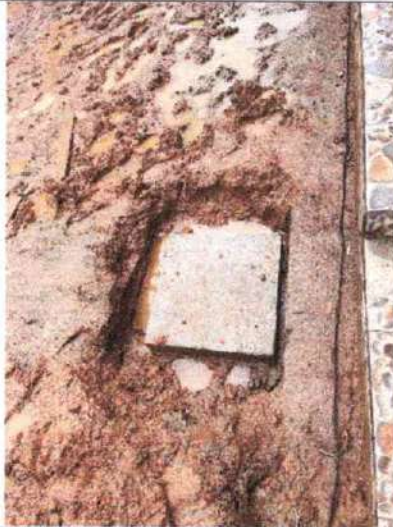
Foto 21. Tapas Cajas de inspección Domiciliarias
