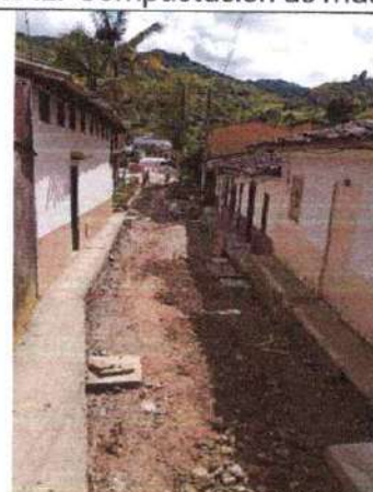
Foto 14. Acabado lleno de brecha
