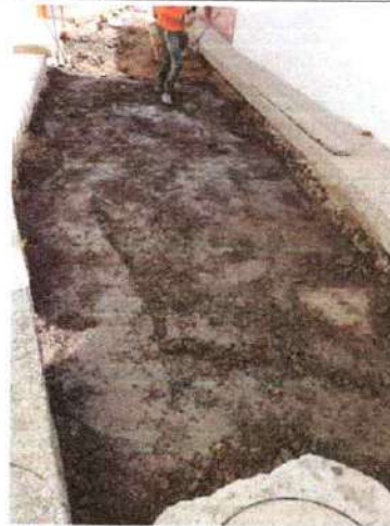
Foto 10. Acabado lleno de brecha
