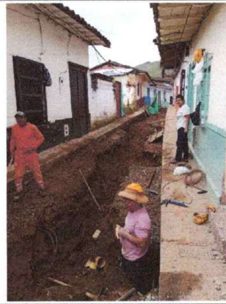
Foto 30. Uso de casco, para labores donde se presentan riesgo de caída de elementos.
