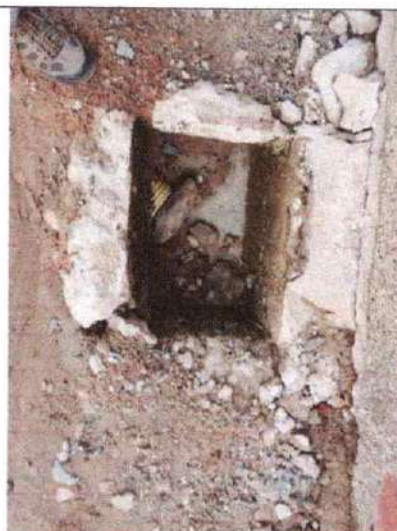
Foto 16. Cajas de Inspección Domiciliarias existente
