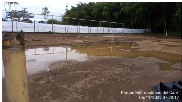
Foto N.6 Afectación lluvias en cancha de tenis.
