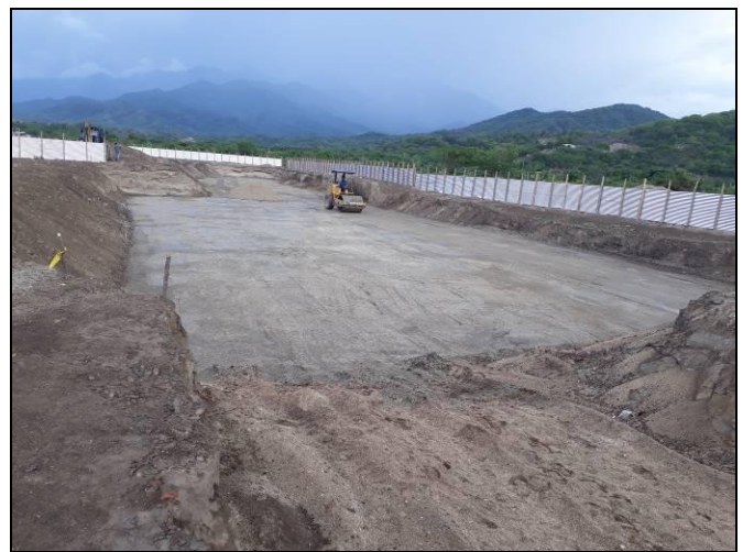
Imagen No. 22. Falta señalización informativa y preventiva general de la obra .
