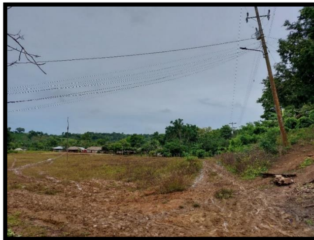
Imagen No.77. Transformadores del caserío en la ubicación del sondeo S2-003- Fuente propia.
