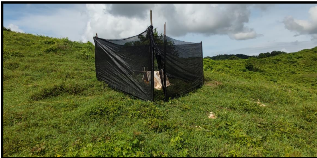
Imagen No. 73. Disposición final de la Estación Remota (receptor y baterías) en sector rural del corregimiento de Santa Lucía de la ciudad de Montería. Fuente propia.
