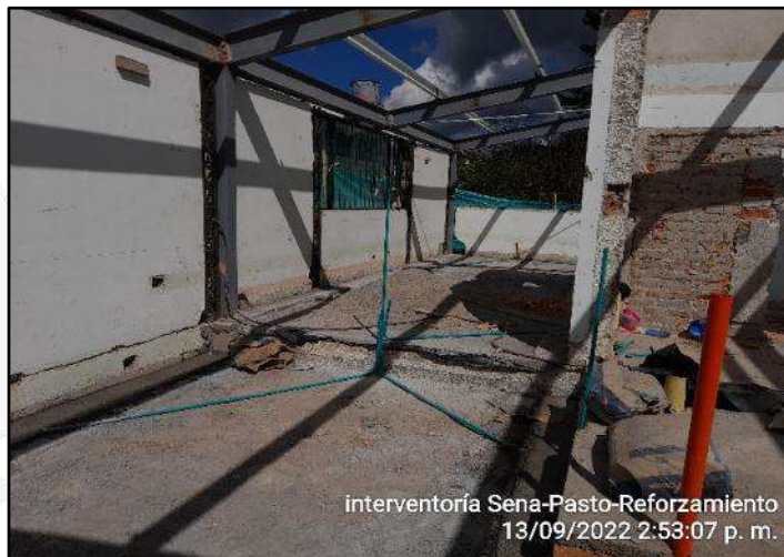
Canalizaciones para cableado eléctrico BT (Tubería conduit).
