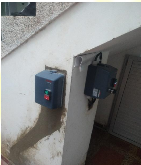
Arrancadores directos y controls automaticos
