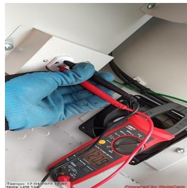
Ilustración 110 – LPR162, conectorización tierra-acometida
