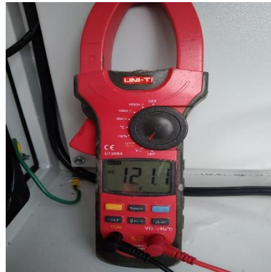
Ilustración 270 - P2152, Energización de punto
