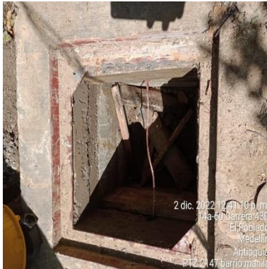
Ilustración 62 - P2147, Instalación tierra
