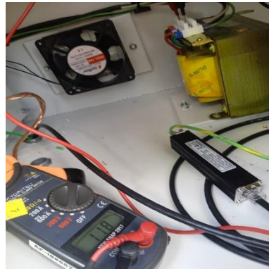
Ilustración 287 - P2149, Energización de punto
