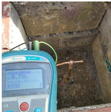
Ilustración 279 – LPR176, Instalación puesta a tierra
