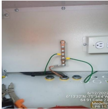
Ilustración 152 – LPR153, Conexión a tierra
