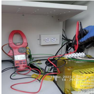
Ilustración 230 – P2147, Energización de punto
