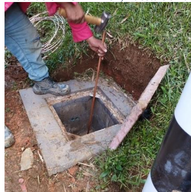
Ilustración 75 – LPR152, Puesta tierra
