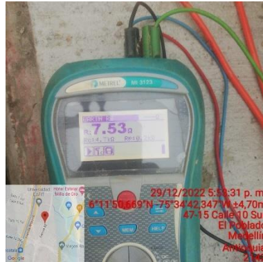
Ilustración 380 – P2142, Instalación puesta a tierra
