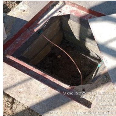
Ilustración 82 – P2165, Instalación tierra
