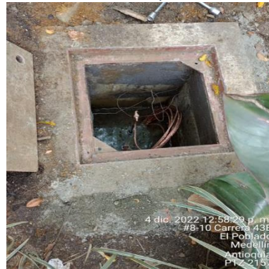
Ilustración 120 – P2157, Instalación tierra
