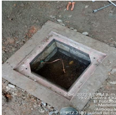
Ilustración 66 - P2151, Instalación tierra
