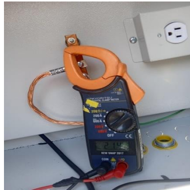
Ilustración 309 - P2145, Energización de punto
