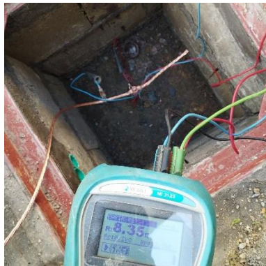
Ilustración 265 - LPR165, Instalación puesta a tierra
