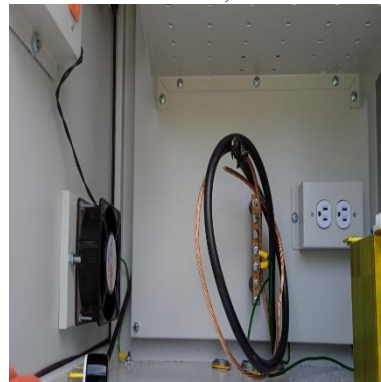
Ilustración 98 – P2162, Instalación tierra
