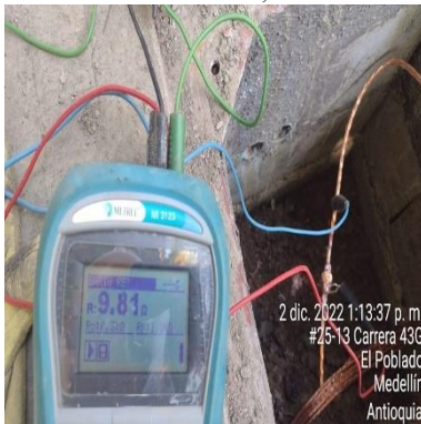
Ilustración 74 – LPR150, Puesta tierra
