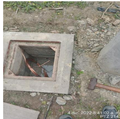
Ilustración 116 – P2143, Instalación tierra
