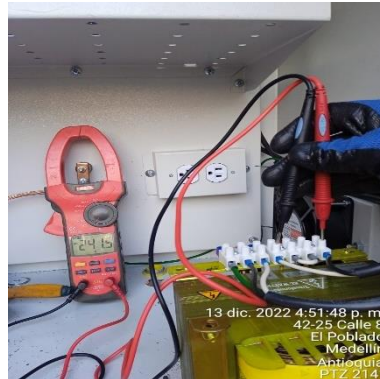
Ilustración 231 – P2141, Energización de punto
