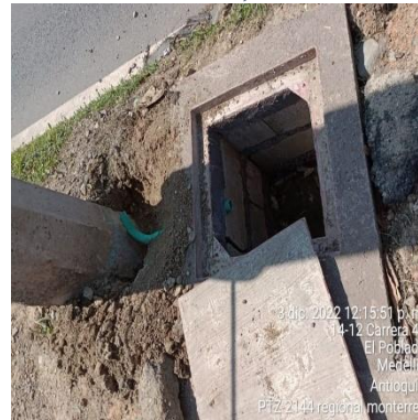
Ilustración 84 – P2144, Instalación tierra
