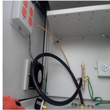
Ilustración 135 – LPR151, Instalación a tierra
