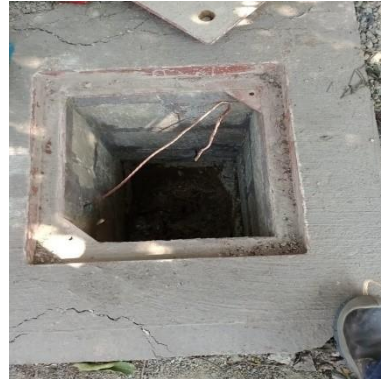
Ilustración 61 – P2146, Instalación tierra
