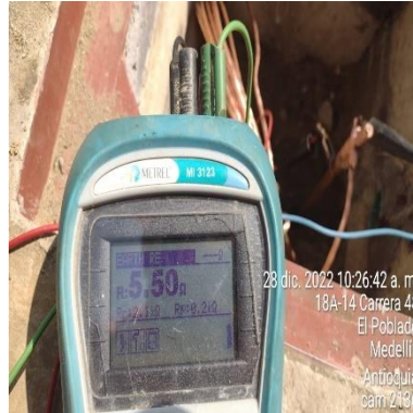
Ilustración 361 - P2136, Instalación puesta a tierra
