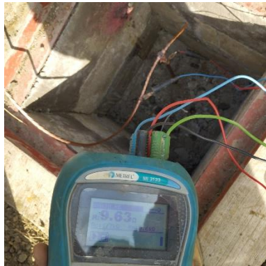
Ilustración 263 - P2140, Instalación puesta a tierra
