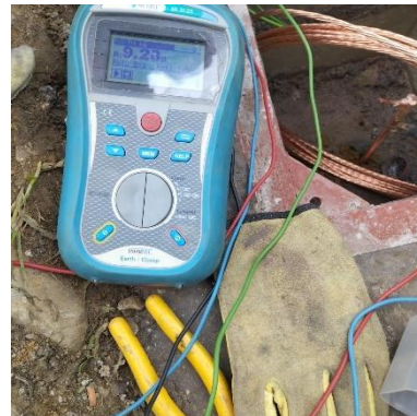
Ilustración 278 - P2165, Instalación puesta a tierra
