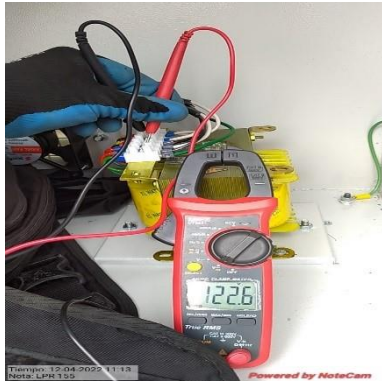
Ilustración 111 – LPR155 conectorización tierra-acometida
