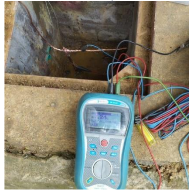
Ilustración 139 – LRP170, Instalación puesta tierra
