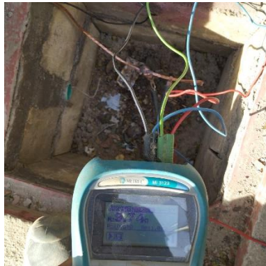
Ilustración 251 – P2158, Instalación puesta a tierra
