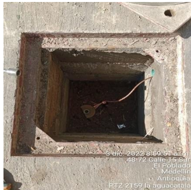
Ilustración 80 – P2159, Instalación tierra
