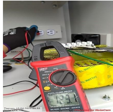
Ilustración 112 – LPR148, conectorización tierra-acometida
