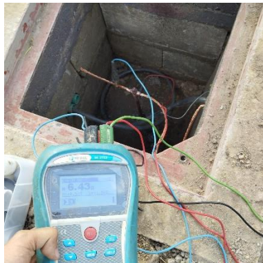
Ilustración 253 – LPR156, Instalación puesta a tierra
