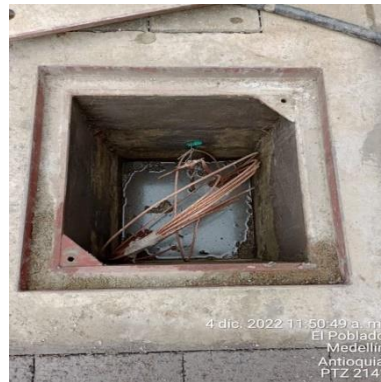
Ilustración 118 – P2141, Instalación tierra
