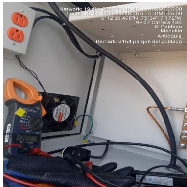
Ilustración 288 - P2164, Energización de punto
