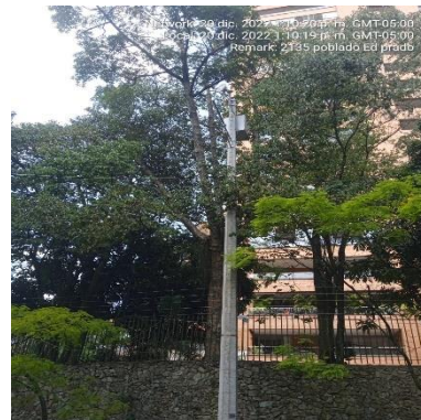
Ilustración 297 - P2135, Energización de punto
