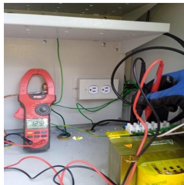
Ilustración 243 – P2157, Energización de punto
