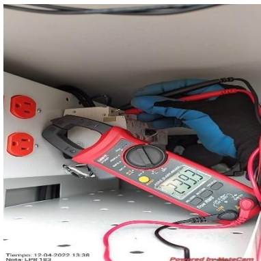
Ilustración 109 – LPR183, conectorización tierra-acometida
