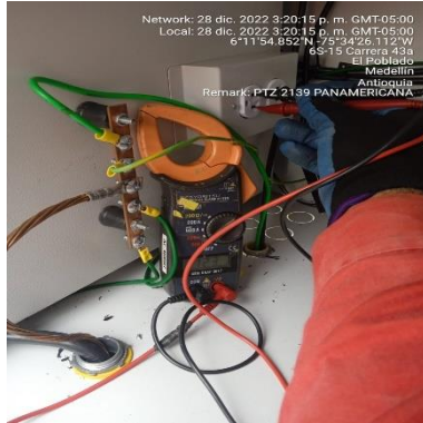
Ilustración 360 - P2139, Energización de punto
