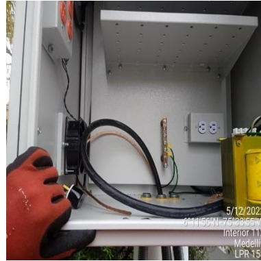
Ilustración 137 – LPR158, Instalación a tierra
