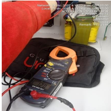
Ilustración 379 – P2156, Energización de punto
