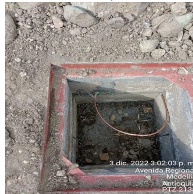
Ilustración 86 – P2138, Instalación tierra
