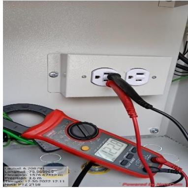
Ilustración 401 - P2158, Energización de punto
