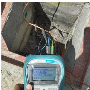
Ilustración 261 - P2166, Instalación puesta a tierra
