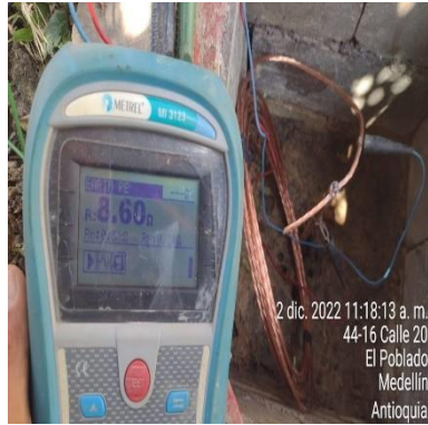
Ilustración 77 – LPR173, Puesta tierra
