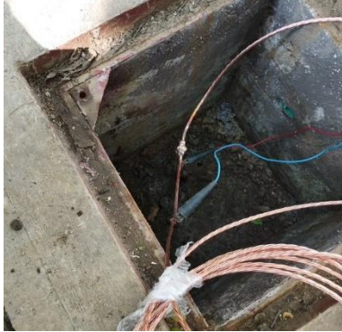
Ilustración 78 – LPR174, Puesta tierra
