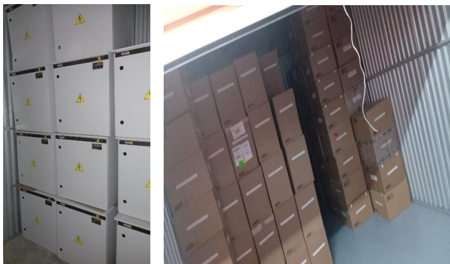
Ilustración 20 Registro fotográfico Equipos
