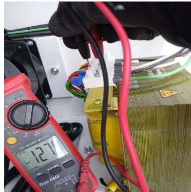
Ilustración 359 – P2140, Energización de punto
