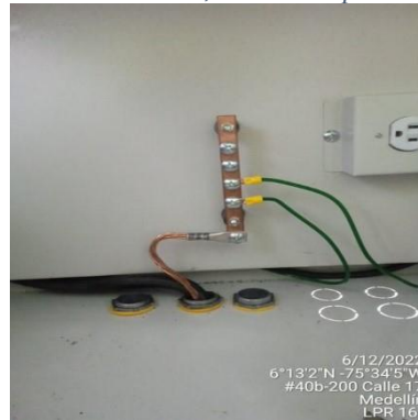
Ilustración 150 – LPR161, Conexión a tierra
