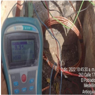
Ilustración 76 – LPR164, Puesta tierra
