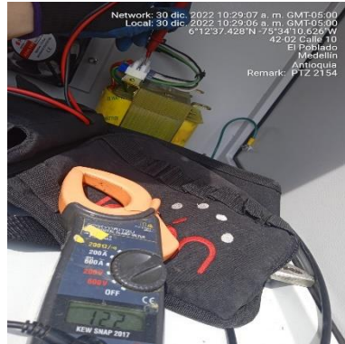
Ilustración 400 – P2154, Energización de punto
