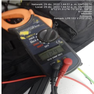
Ilustración 377 – P2167, Energización de punto
