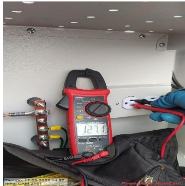
Ilustración 327 – P2160, Energización de punto
