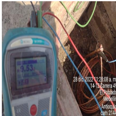
Ilustración 362 - P2144, Instalación puesta a tierra
