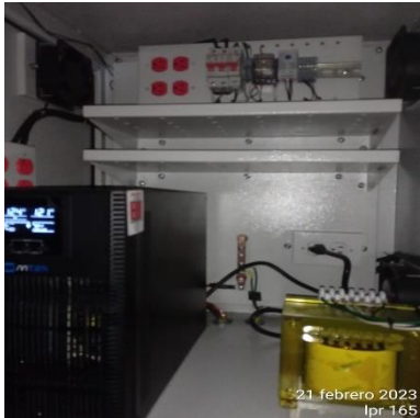
Ilustración 112 – LPR165, Instalación de UPS
