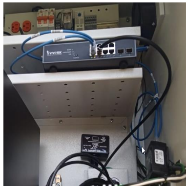
Ilustración 50 - P2162, Instalación de Switch
