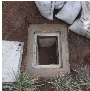
Ilustración 84 – LPR181, Caja de registro
