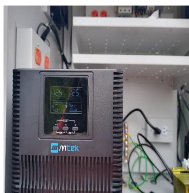
Ilustración 118 – LPR180, Instalación de UPS
