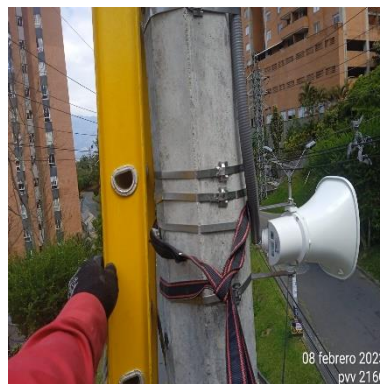
Ilustración 57 – P2160, Instalación de Altavoz
