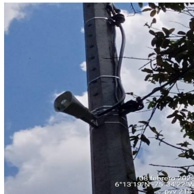
Ilustración 61 - P2151, Instalación de Altavoz
