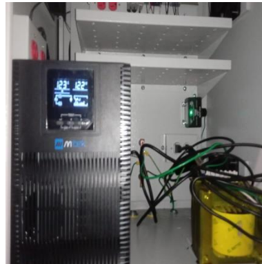
Ilustración 99 – LPR176, Instalación de UPS
