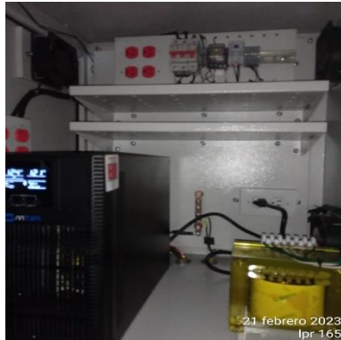
Ilustración 111 – LPR163, Instalación de UPS
