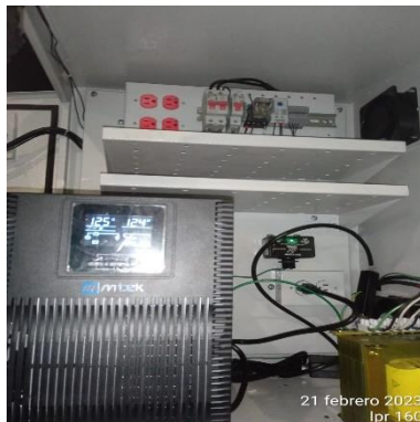
Ilustración 100 – LPR160, Instalación de UPS
