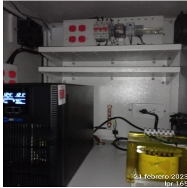
Ilustración 119 – LPR182, Instalación de UPS
