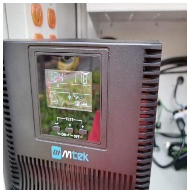
Ilustración 114 – LPR169, Instalación de UPS
