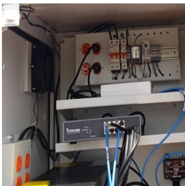
Ilustración 75 - P2138, Instalación de Switch
