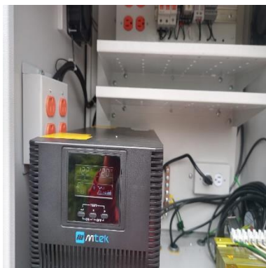
Ilustración 113 – LPR168, Instalación de UPS
