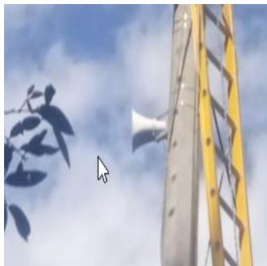
Ilustración 51 - P2162, Instalación de Altavoz
