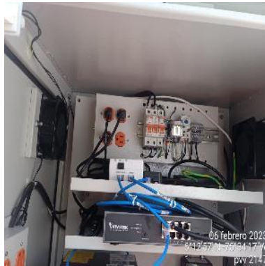
Ilustración 42 - P2147, Instalación de Switch
