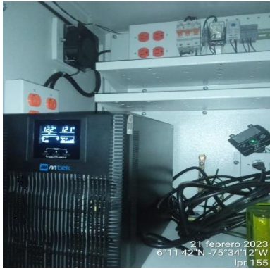
Ilustración 108 – LPR155, Instalación de UPS
