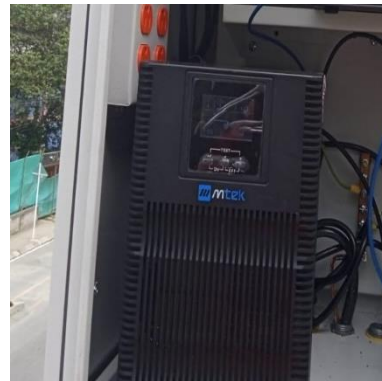
Ilustración 81 – LPR156, Instalación de UPS
