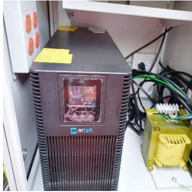
Ilustración 107 – LPR152, Instalación de UPS
