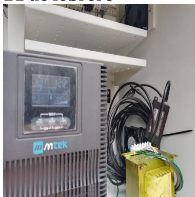
Ilustración 105 – LPR148, Instalación de UPS
