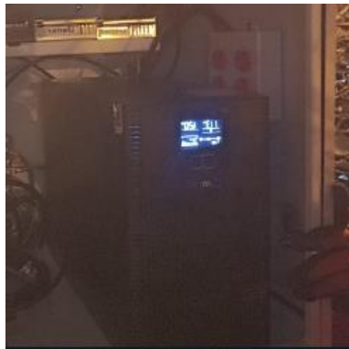
Ilustración 144 – LPR179, Instalación de UPS
