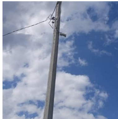
Ilustración 74 - P2138, Instalación de Altavoz
