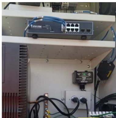
Ilustración 56 - P2160, Instalación de Switch
