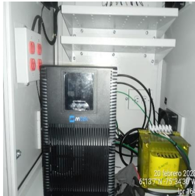
Ilustración 102 – LPR164, Instalación de UPS
