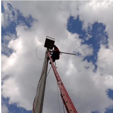
Ilustración 71 - P2138, Instalación de brazo soporte
