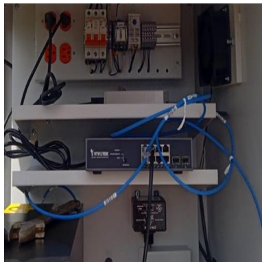
Ilustración 60 - P2151, Instalación de Switch
