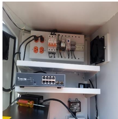
Ilustración 46 - P2150, Instalación de Switch
