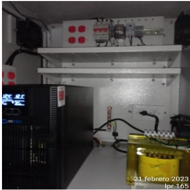
Ilustración 110 – LPR161, Instalación de UPS
