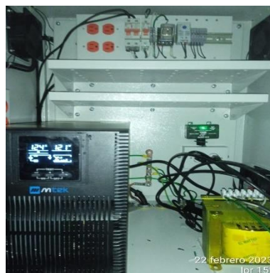
Ilustración 106 – LPR151, Instalación de UPS
