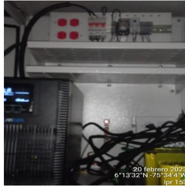
Ilustración 97 - LPR153, Instalación de UPS
