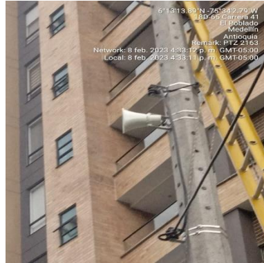
Ilustración 65 – P2163, Instalación de Altavoz
