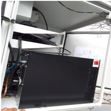
Ilustración 22 – LPR173, Instalación de ups
