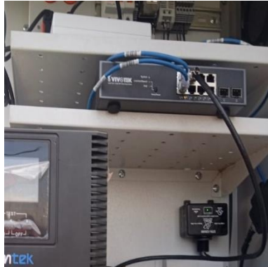
Ilustración 64 - P2163, Instalación de Switch
