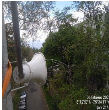
Ilustración 43 – P2147, Instalación de Altavoz
