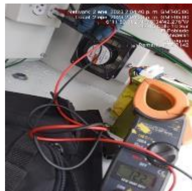
Ilustración 14 - P2142, Energización de punto
