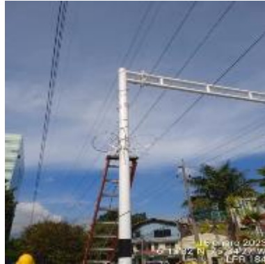
Ilustración 91 – LPR184, Instalación de concertina en vertical lado opuesto
