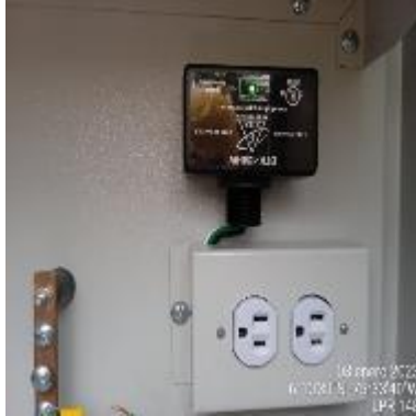
Ilustración 15 – LPR148, Instalación de protección de energía
