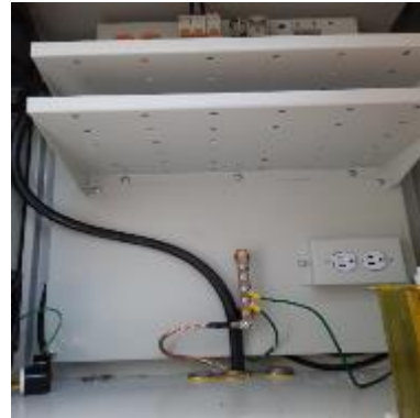
Ilustración 10 – LPR150, Conexión de tierra
