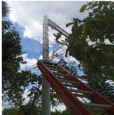
Ilustración 66 – LPR168, Instalación de concertina en vertical lado opuesto
