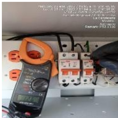
Ilustración 165 - P2138, Energización de punto
