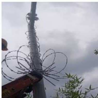
Ilustración 59 – LPR148, Instalación de concertina en vertical del lado opuesto
