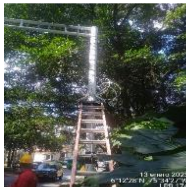
Ilustración 77 – LPR174, Instalación de concertina en vertical lado opuesto
