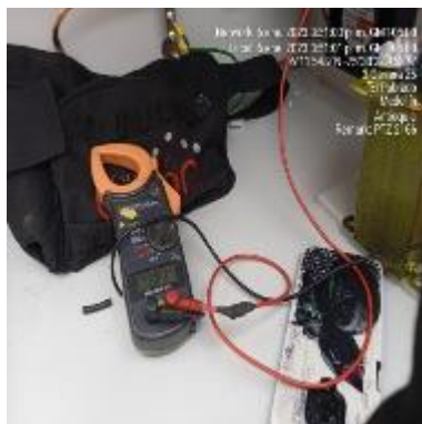
Ilustración 49 - P2166, Energización de punto
