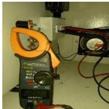
Ilustración 143 – P2165, Energización de punto
