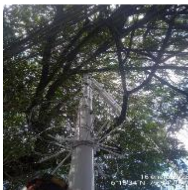
Ilustración 88 – LPR150, Instalación de concertina en vertical lado opuesto
