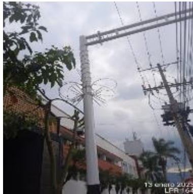
Ilustración 74 – LPR164, Instalación de concertina en vertical lado opuesto
