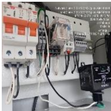
Ilustración 17 – LPR160, Instalación de protección de energía
