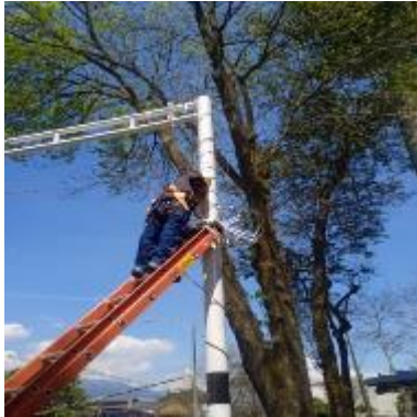
Ilustración 90 – LPR179, Instalación de concertina en vertical lado opuesto
