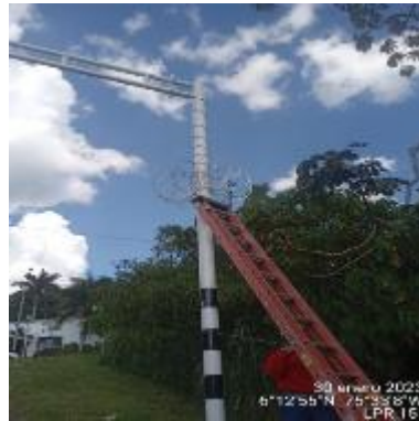
Ilustración 180 – LPR151, Instalación de concertina en vertical lado opuesto
