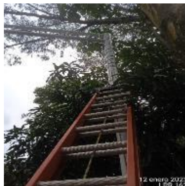
Ilustración 65 – LPR162, Instalación de concertina en vertical lado opuesto
