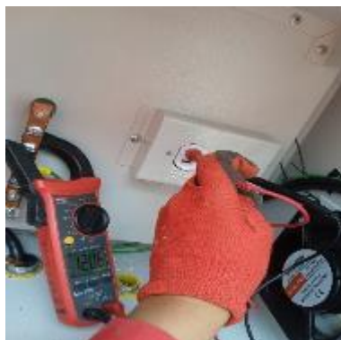
Ilustración 13 - P2155, Energización de punto
