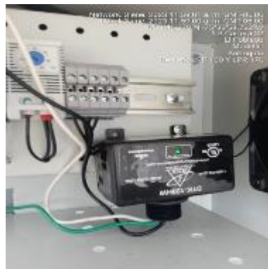
Ilustración 18 – LPR176, Instalación de protección de energía
