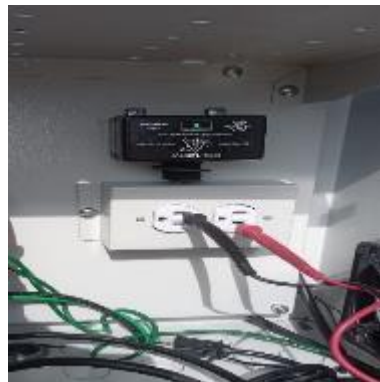
Ilustración 182 – LPR151, Instalación de protector de voltaje
