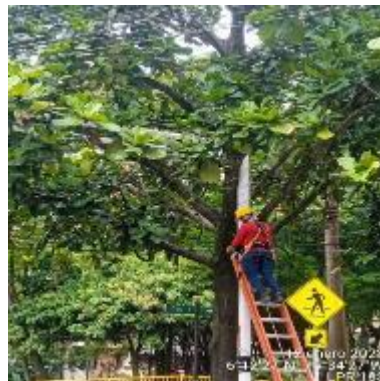
Ilustración 63 – LPR183, Instalación de concertina en vertical lado opuesto
