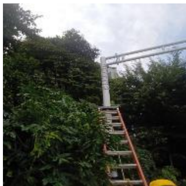
Ilustración 64 – LPR155, Instalación de concertina en vertical lado opuesto
