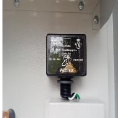
Ilustración 16 – LPR155, Instalación de protección de energía
