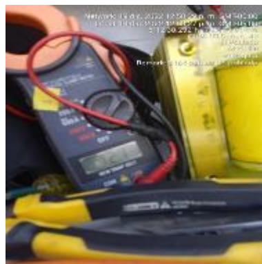
Ilustración 71 - P2153, Energización de punto
