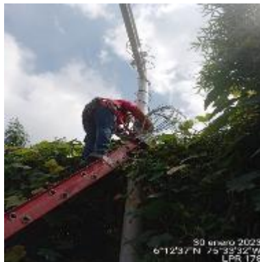
Ilustración 181 – LPR178, Instalación de concertina en vertical lado opuesto
