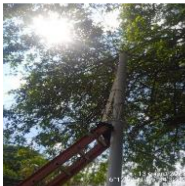
Ilustración 76 – LPR149, Instalación de concertina en vertical lado opuesto
