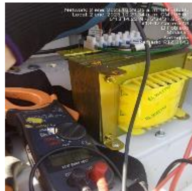
Ilustración 12 - P2143, Energización de punto
