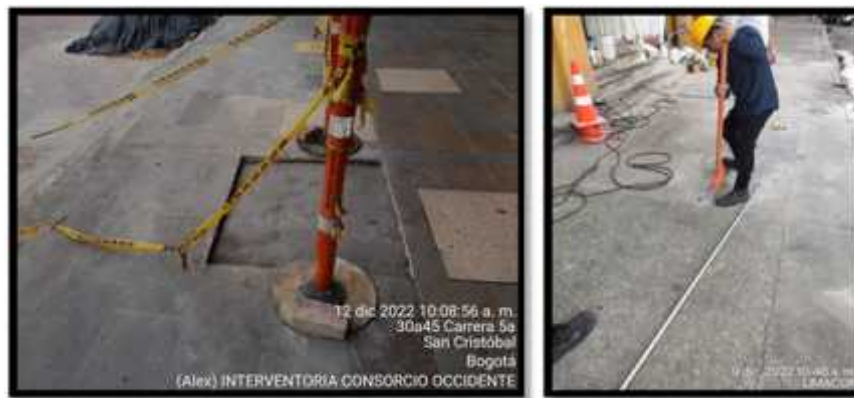
Ilustración 1. Señalización. Tomado en el mes de diciembre de 2022.
