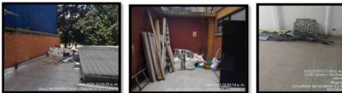
Ilustración 3. Residuos generados y acopiados. Tomado en el mes de enero del 2023.
