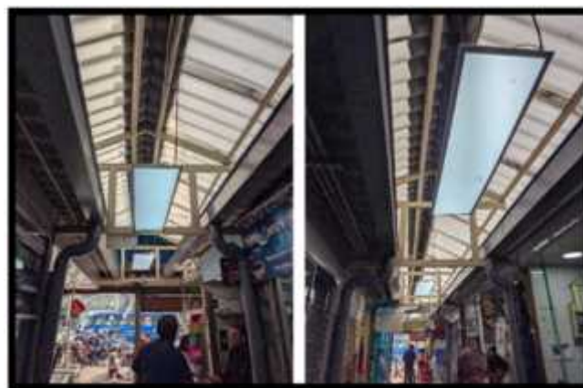
Ilustración 6. Nuevas Luminarias. Tomado en el mes de enero del 2023.
