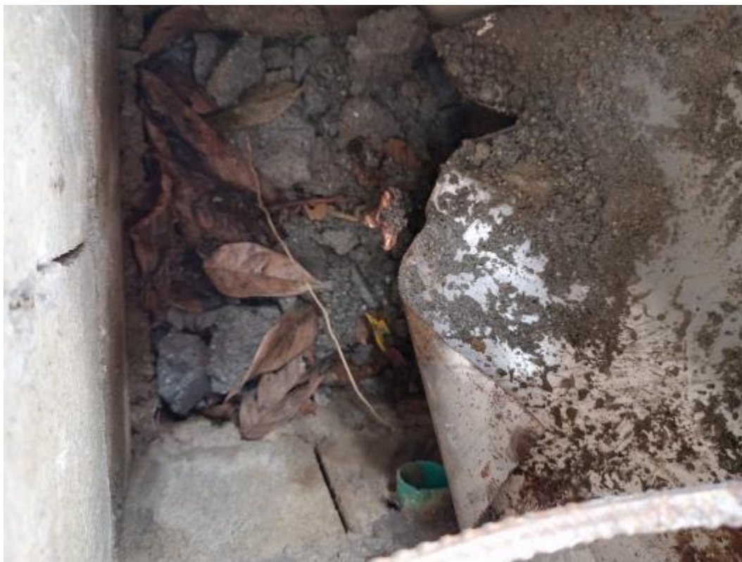
Ilustración 9 – P2144, Caja vandalizada rompieron y se hurtaron la tierra 20/02/2023
