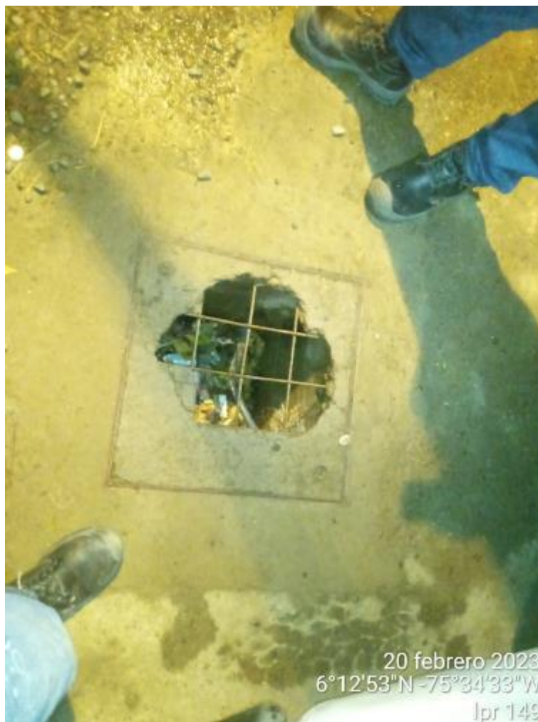
Ilustración 1 – LPR149, Caja vandalizada, hurtaron 20 metros de acometida y 10 metros de cable de tierra 20/02/2023
