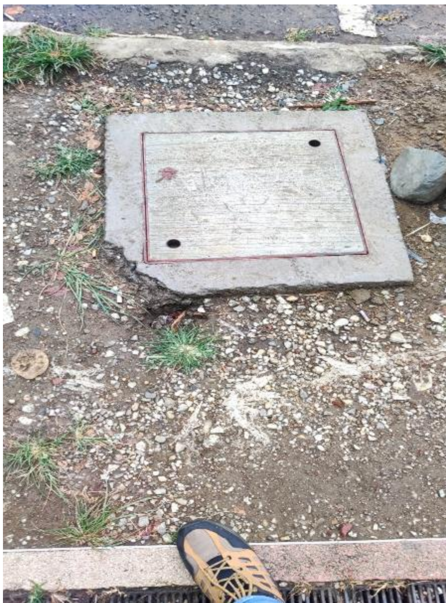
Ilustración 13 – P2153, Tapa quebrada en la esquina. 21/02/2023
