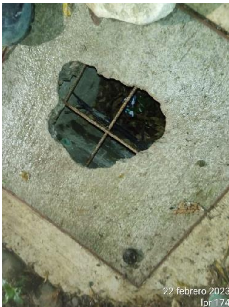
Ilustración 5 – LPR174, Tapa vandalizada, hurtaron 25 metros de acometida 22/02/2023
