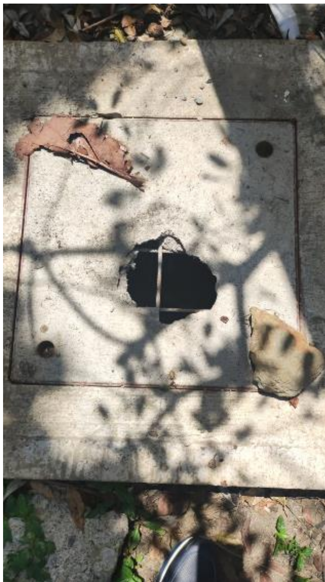
Ilustración 11 – P2146, Tapa vandalizada, Cortan el cable de cobre #8 21/02/2023
