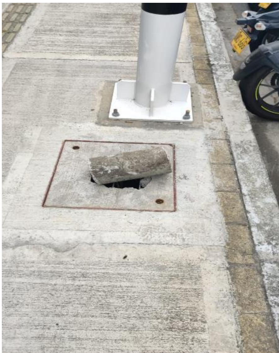
Ilustración 6 – LPR176, Hurto de acometida eléctrica y cable de tierra #8 21/02/2023
