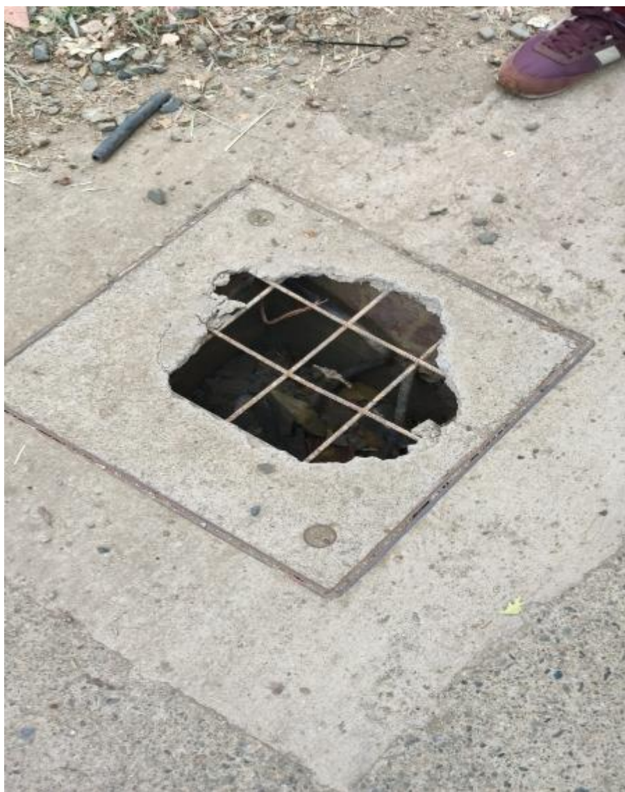
Ilustración 8 – P2138, Tapa vandalizada, Cortan el cable de cobre #8 21/02/2023
