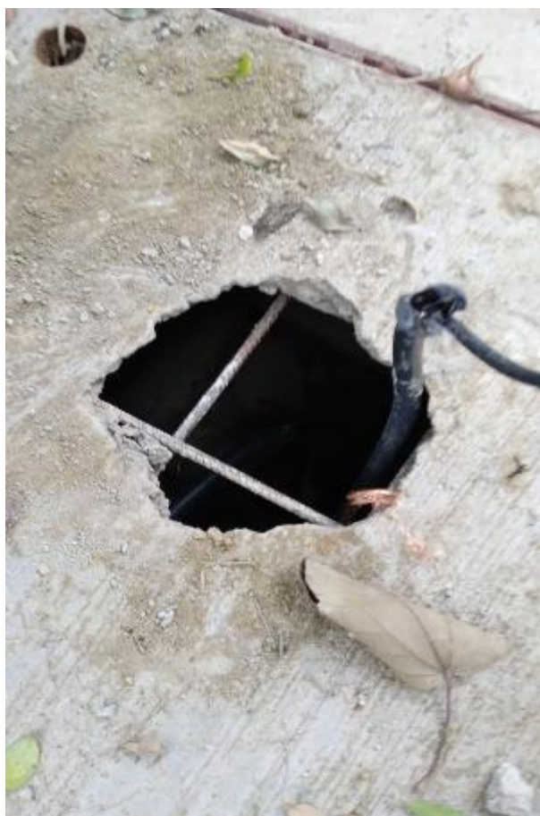
Ilustración 3 – LPR173, Tapa vandalizada, hurtaron 10 metros de acometida 22/02/2023
