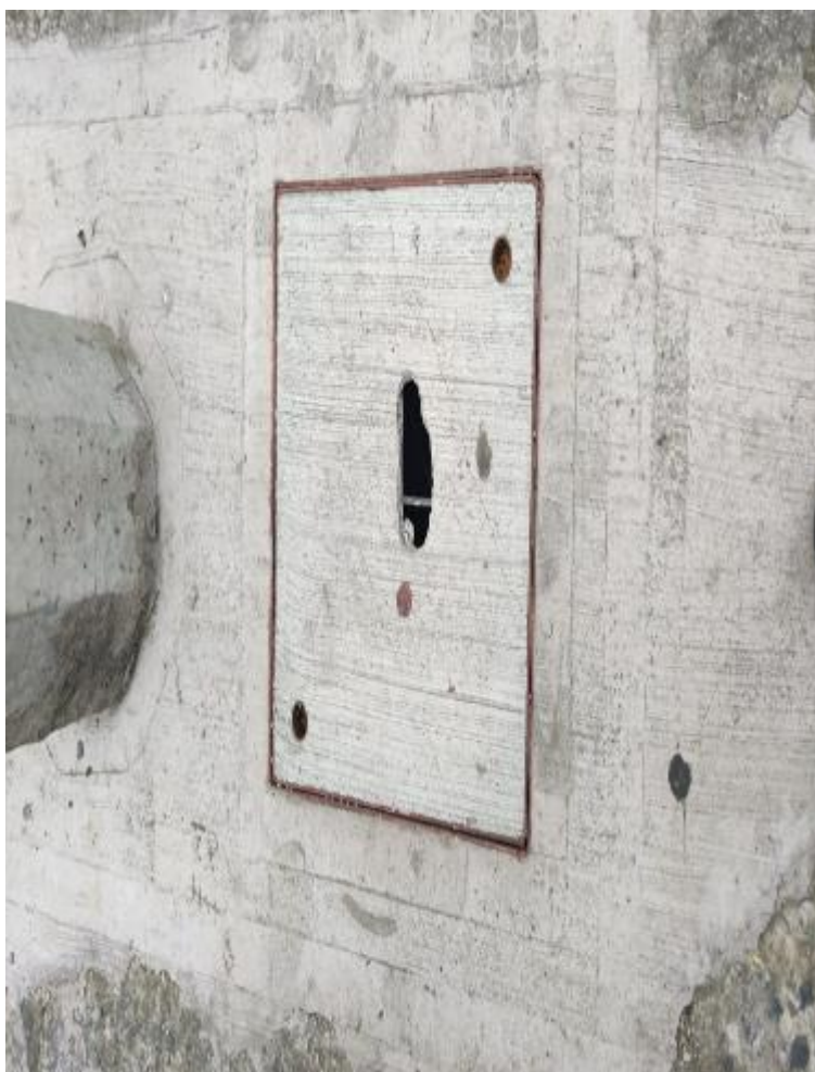
Ilustración 10 – P2145, Tapa vandalizada, Cortan el cable de cobre #8 21/02/2023
