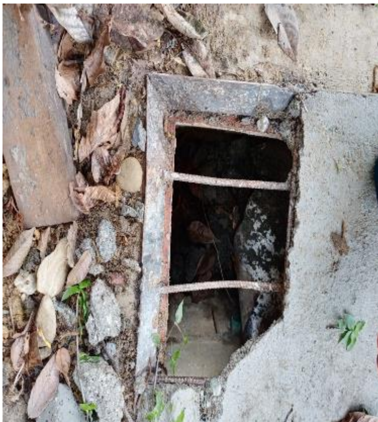
Ilustración 4 – LPR166, Tapa vandalizada, cortan la acometida eléctrica 15/02/2023
