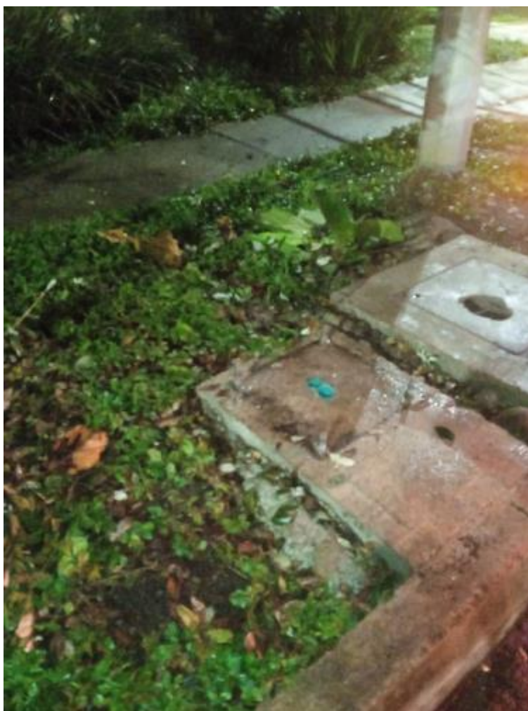
Ilustración 7 – LPR183, Tapa vandalizada, Cortan el cable de cobre #8 14/02/2023
