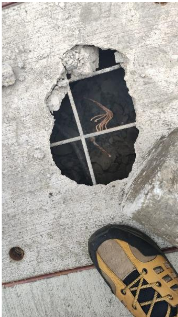
Ilustración 12 – P2152, Tapa vandalizada, Cortan el cable de cobre #8 17/02/2023
