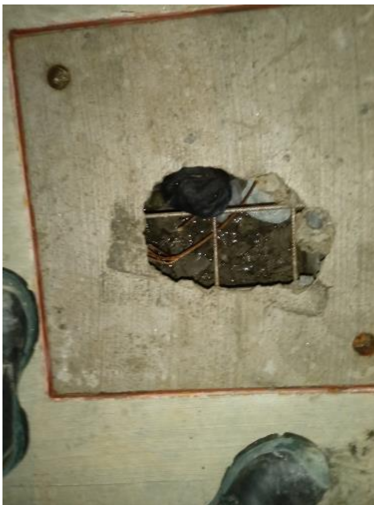
Ilustración 2 – LPR164, Tapa vandalizada, Cortan el cable de cobre #8 21/02/2023
