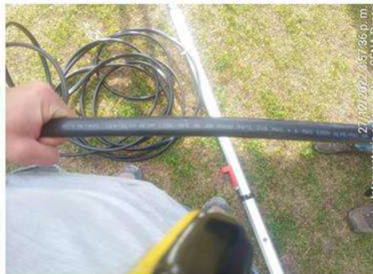
Cable encauchetado acometida eléctrica hasta tablero de distribución
