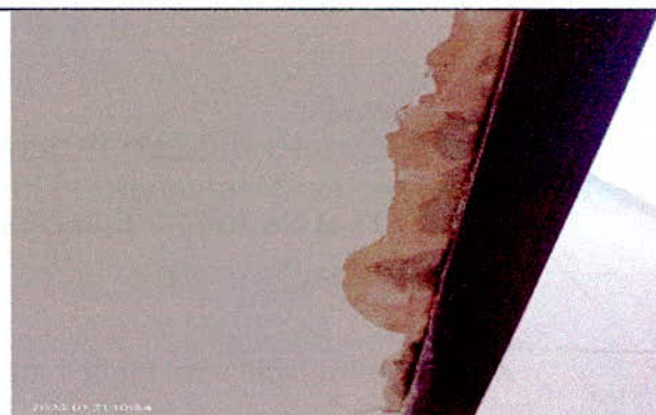
Estado pared habitacion
