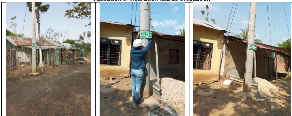
Ilustración 6. Instalación ruta de evacuación
