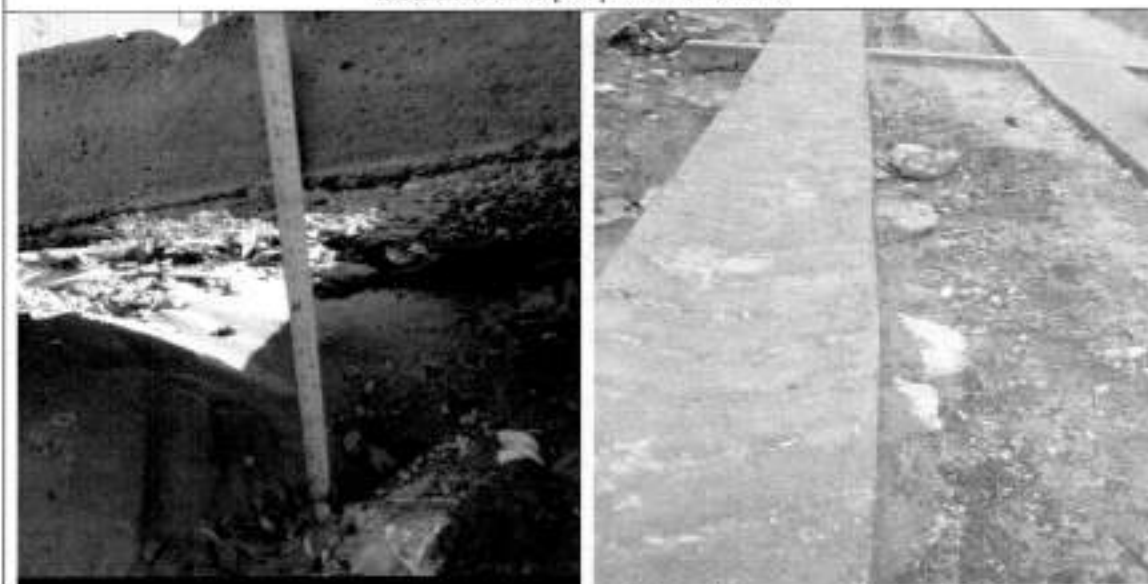
Daños en cintas por lluvias, arraste de material de subbase y arreglo con ciclopeo,
