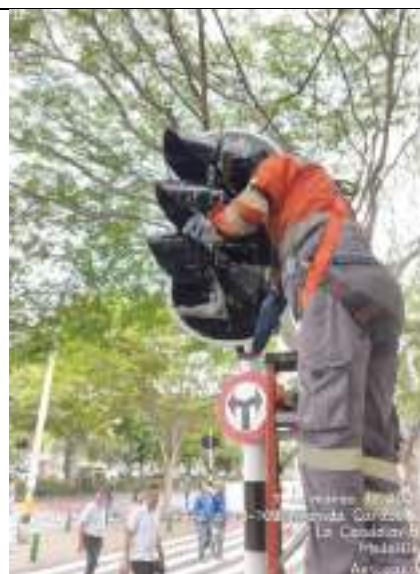
Fotografía 22: Lavada poste de semáforo Carrera 52 con calle 44
