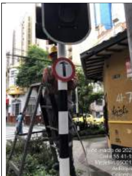
Fotografía 3: Disco direccional Carrera 41 con calle 55
