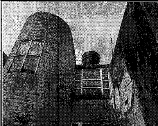
TANQUE DE RESERVA
