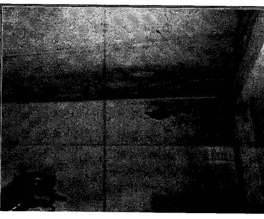
HUMEDADES EN CUARTO BASURAS
