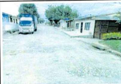
Estado inicial vía con pavimento deteriorado. Calle 1A entre Carreras 41 y 42B. Barrio La María Occidente
