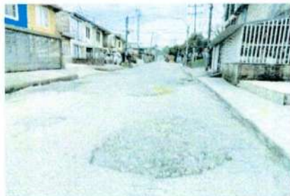
Estado inicial vía con presencia de baches. Carrera 37 entre Calles 2 y 4A. Barrio Carlos Primero
