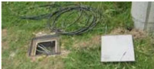
Caja de inspección con marco metálico y tapa
