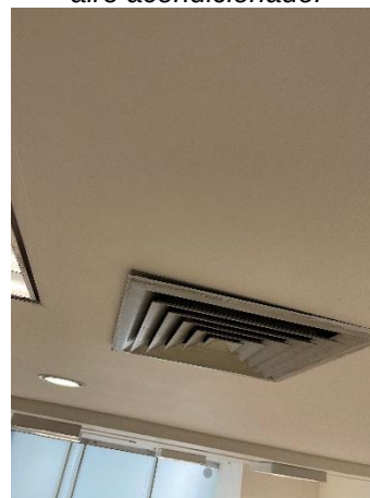
Imagen N° 10. Visita para verificar equipos de aire acondicionado.
