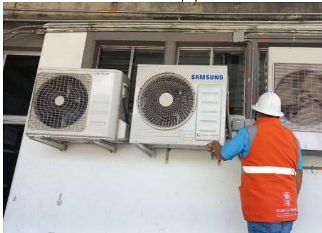
Imagen N° 13. Revisión de mantenimiento realizado a equipos.
