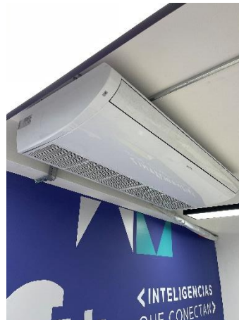
Imagen N° 29. Visita para verificar equipos de aire acondicionado.
