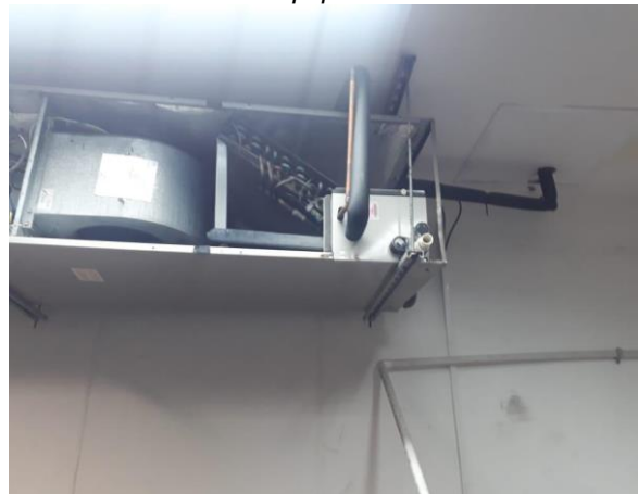
Imagen N° 8. Mantenimiento preventivo de equipos.
