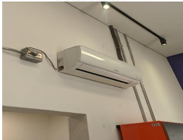
Imagen N° 27. Visita para verificar equipos de aire acondicionado.
