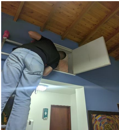
Imagen N° 18. Visita para verificar equipos de aire acondicionado.
