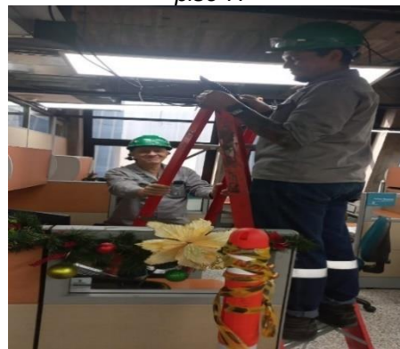
Imagen N° 182. Conexión de Potencia CVV piso 7.
