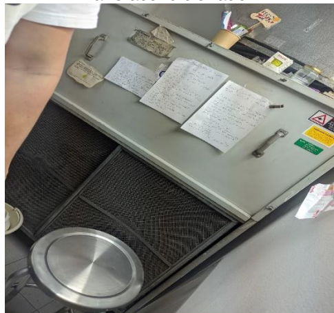
Imagen N° 12. Visita para verificar equipos de aire acondicionado.
