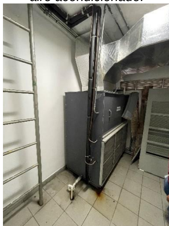
Imagen N° 9. Visita para verificar equipos de aire acondicionado.
