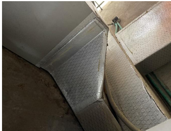
Imagen N° 19. Visita para verificar equipos de aire acondicionado.
