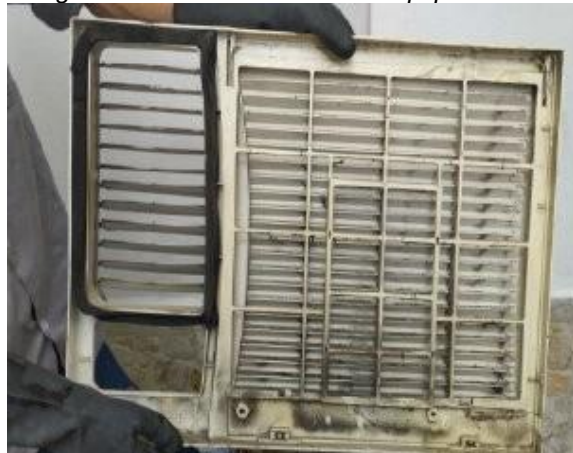
Imagen N° 48. Mtto Preventivo Equipos de AA.
