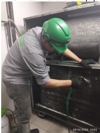
Imagen N° 49. Mtto Preventivo Equipos de AA.
