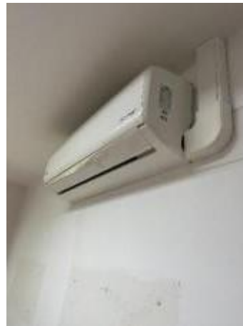
Imagen N° 40. Visita para verificar equipos de aire acondicionado.
