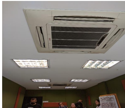
Imagen N° 21. Visita para verificar equipos de aire acondicionado.
