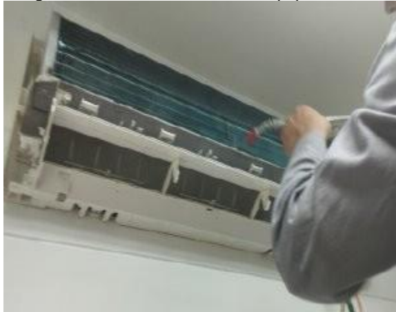
Imagen N° 35. Mtto Preventivo Equipos de AA.
