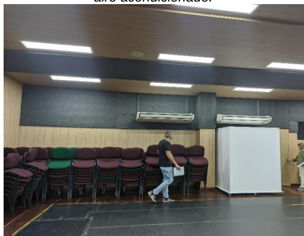
Imagen N° 17. Visita para verificar equipos de aire acondicionado.
