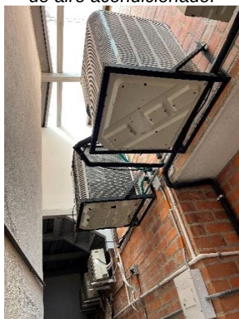
Imagen N° 16. Visita para verificar equipos de aire acondicionado.
