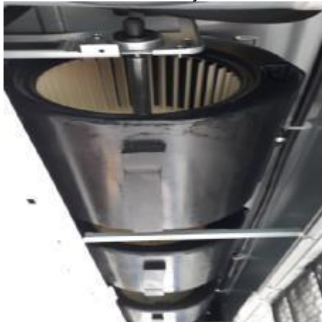
Imagen N° 27. Mantenimiento preventivo unidades manejadoras.
