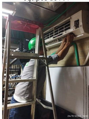
Imagen N° 166. Revisión de mantenimiento de equipos de AA
