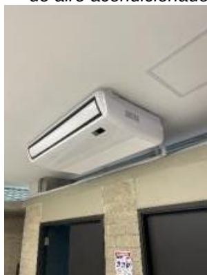
Imagen N° 29. Visita para verificar equipos de aire acondicionado.
