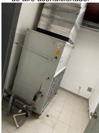
Imagen N° 15. Visita para verificar equipos de aire acondicionado.
