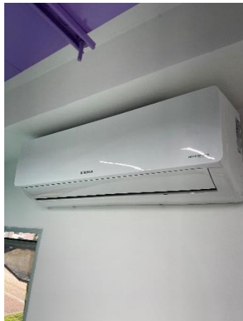
Imagen N° 28. Visita para verificar equipos de aire acondicionado.
