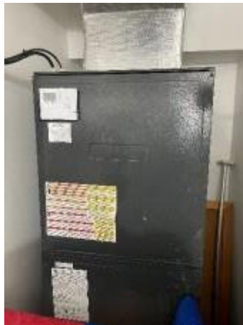
Imagen N° 39. Visita para verificar equipos de aire acondicionado.
