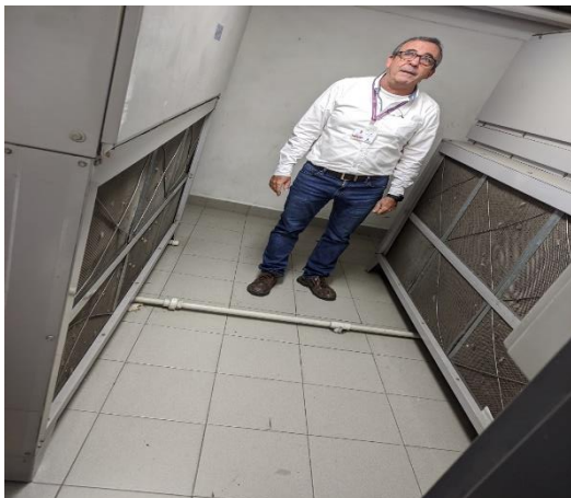
Imagen N° 13. Visita para verificar equipos de aire acondicionado.
