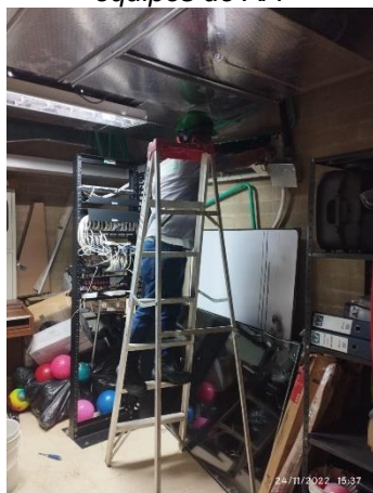
Imagen N° 165. Revisión de mantenimiento de equipos de AA
