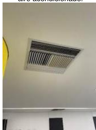
Imagen N° 36. Visita para verificar equipos de aire acondicionado.
