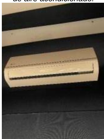
Imagen N° 35. Visita para verificar equipos de aire acondicionado.
