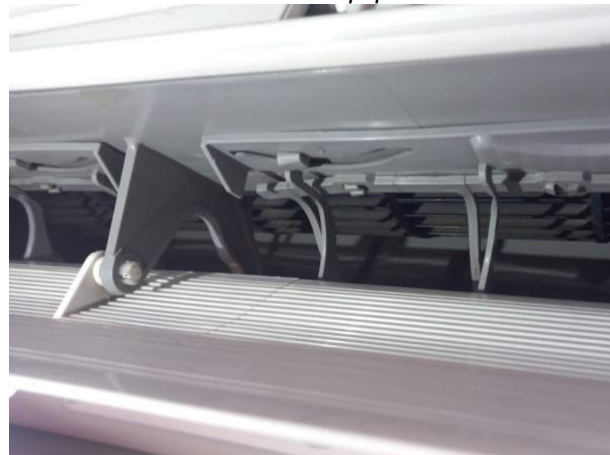
Imagen N° 14. Revisión de mantenimiento realizado a equipos.
