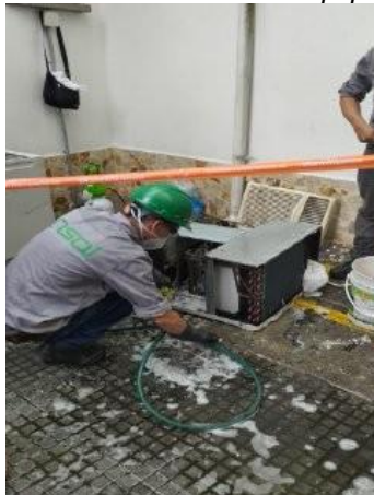
Imagen N° 47. Mtto Preventivo Equipos de AA.
