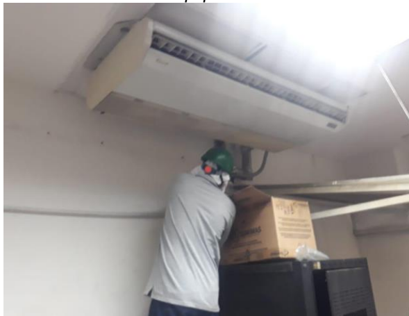
Imagen N° 7. Mantenimiento preventivo de equipos.
