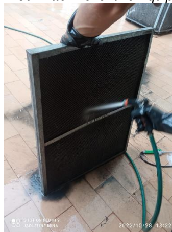
Imagen N° 50. Mtto Preventivo Equipos de AA.
