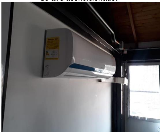
Imagen N° 22. Visita para verificar equipos de aire acondicionado.
