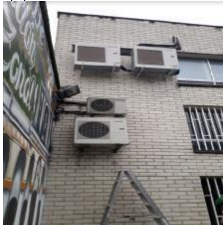
Imagen N° 28. Mantenimiento preventivo de equipos AA - Unidades Condensadoras
