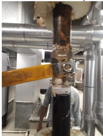
Imagen N° 17. Revisión y diagnóstico de válvula en cuarto técnico piso 13.
