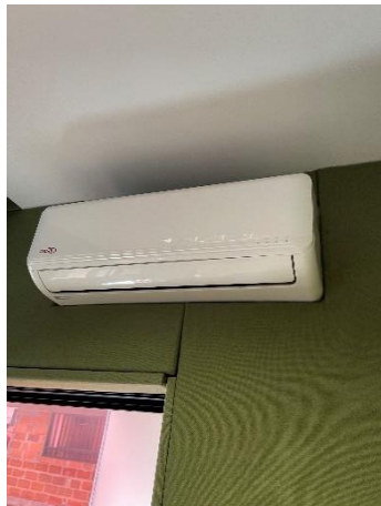
Imagen N° 20. Visita para verificar equipos de aire acondicionado.
