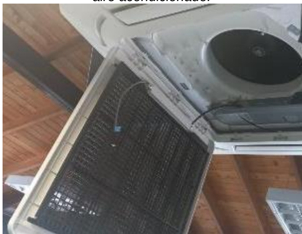
Imagen N° 23. Visita para verificar equipos de aire acondicionado.
