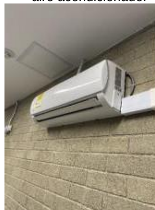
Imagen N° 30. Visita para verificar equipos de aire acondicionado.
