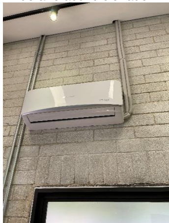
Imagen N° 26. Visita para verificar equipos de aire acondicionado.
