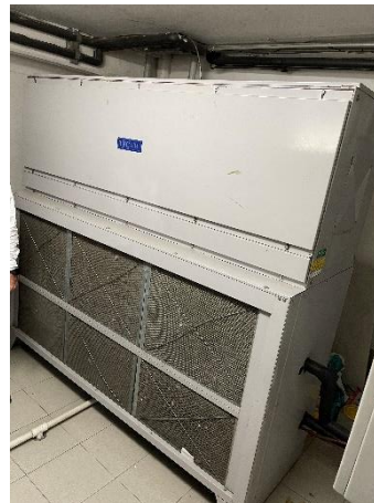
Imagen N° 14. Visita para verificar equipos de aire acondicionado.
