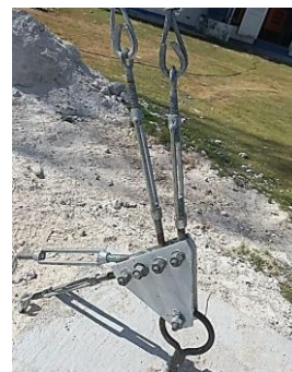
Anclaje de vientos
