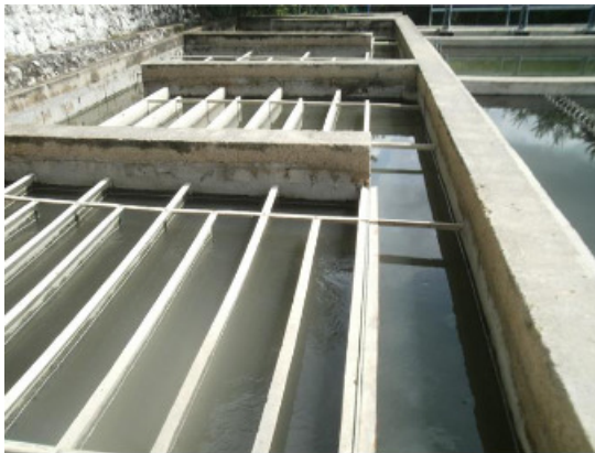
Cámara de aquietamiento
