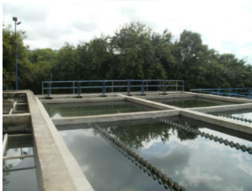
Sedimentación y Floculación
