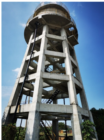
Figura 8. Tanque Elevado en Pendales.
