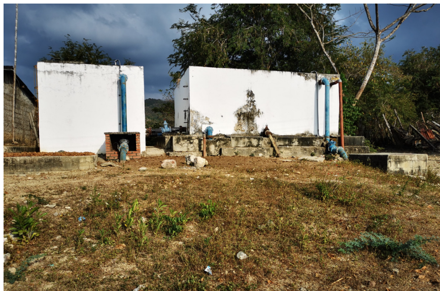
Figura 10. Tanques de Almacenamiento en Palmar de Candelaria.
