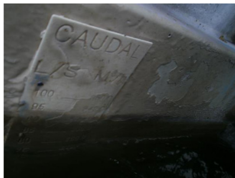
Toma de caudal de entrada a planta
