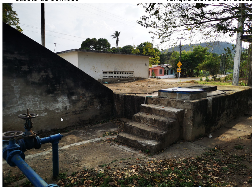
Tanque de Almacenamiento
