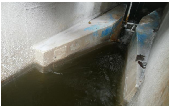
Dosificación de químicos
