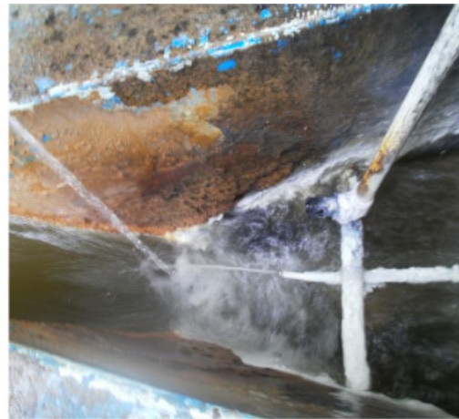
Canaleta Parshall y dosificación de coagulante.
