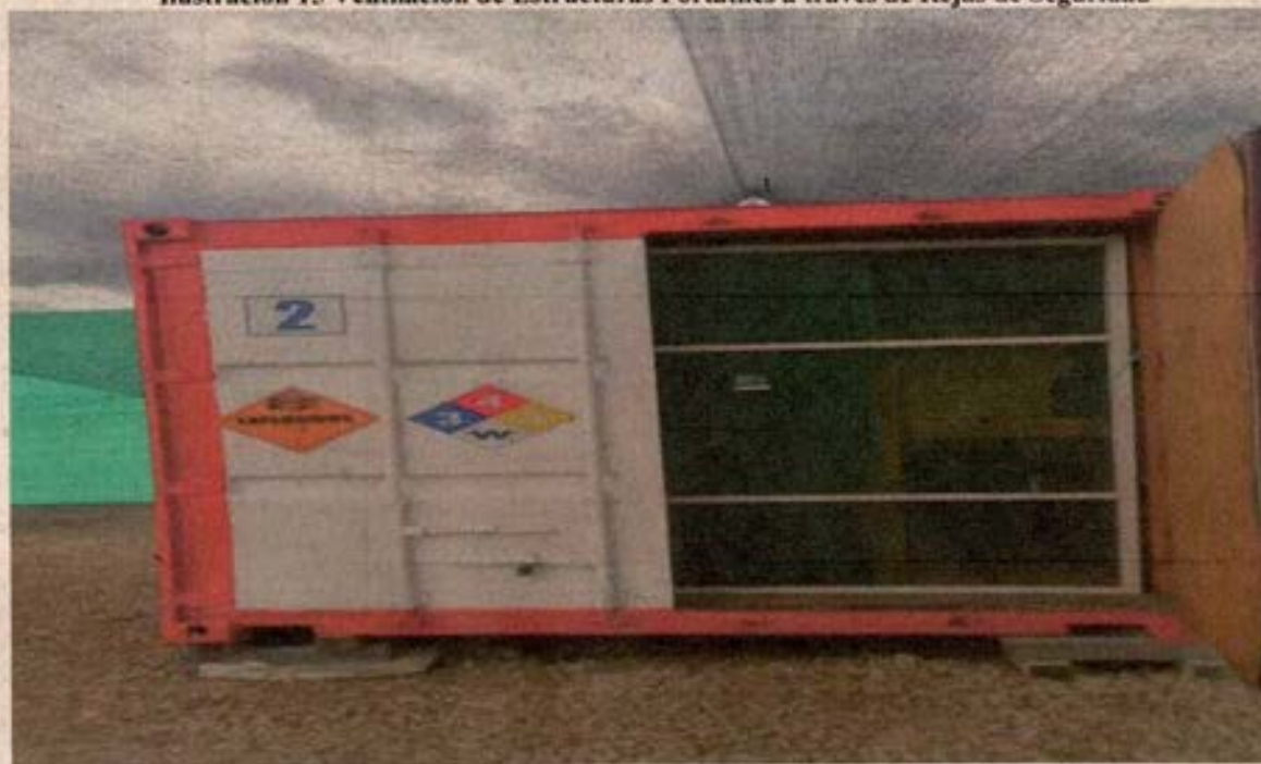
Ilustración 16 Ventilación de Estructuras Portátiles a través de Rejas de Seguridad
