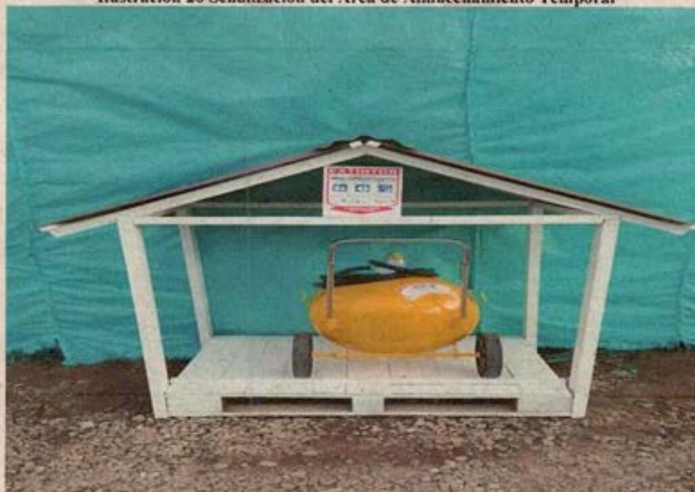
Ilustración 21 Extintor Satélite al Interior del lugar de Almacenamiento Temporal
