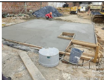
Adecuación de otro lavadero de llantas
