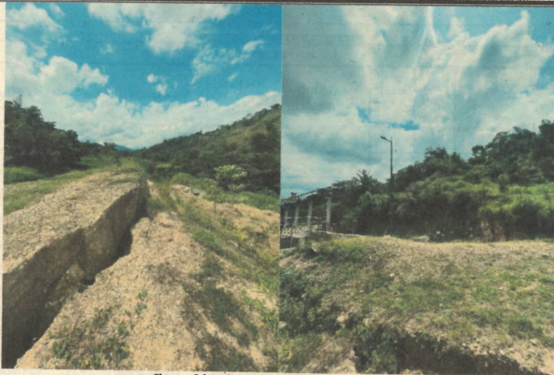
Figura 2 Inestabilidad estructura preliminar
