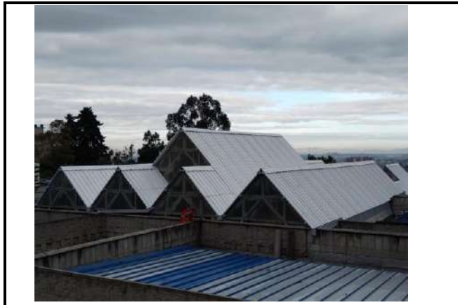
UBICACIÓN: BLOQUE DE PRIMARIA COMENTARIOS: CAMBIO DE TEJAS Y CABALLETES
