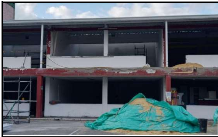
UBICACIÓN: EDIFICIO NORTE COMENTARIOS: ESTUCO SOBRE PAÑE DE MUROS Y ANTEPECHOS EN DOS PISOS
