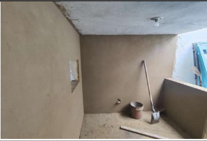
UBICACIÓN: CASA DE DOS PISOS COMENTARIOS: PAÑETES SOBRE MUROS DE COCINA
