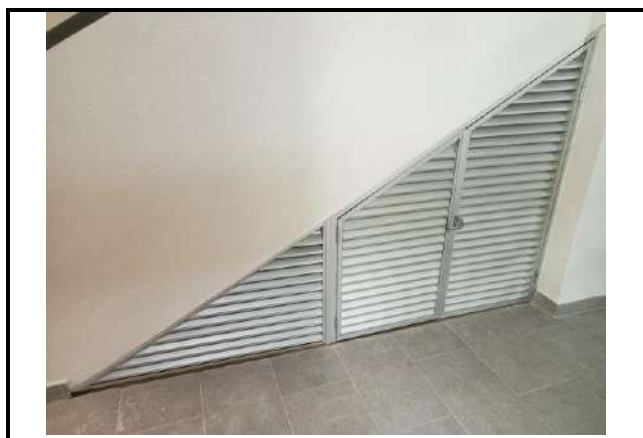
UBICACIÓN: BODEGA PISO 1 COMENTARIOS: INSTALACION DE PUERTA EN ALUMINIO SOLICITADA A ULTIMA HORA
