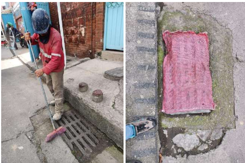
Ilustración 28 . Protección de sumideros aledaños a las instituciones educativas intervenidas, Colegio Nueva Zelandia – Sede A. Fecha: 28 de abril de 2023
