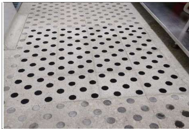
UBICACIÓN: COCINA COMENTARIOS: INSTALACION ANTIDESLIZANTE
