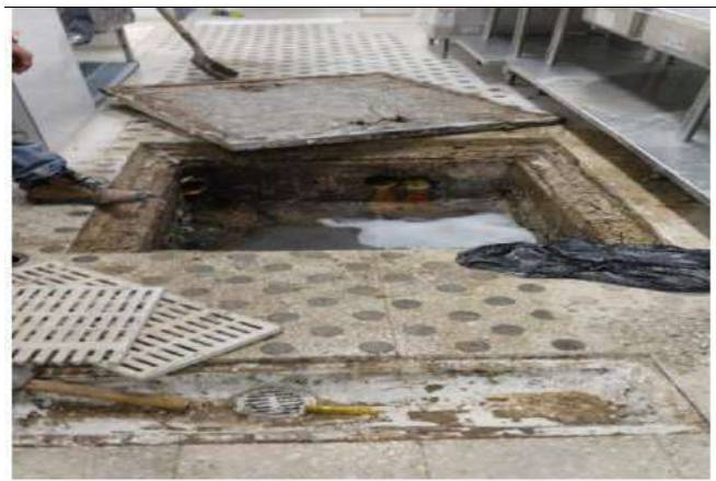
UBICACIÓN: COCINA COMENTARIOS: LIMPIEZA CAJA
