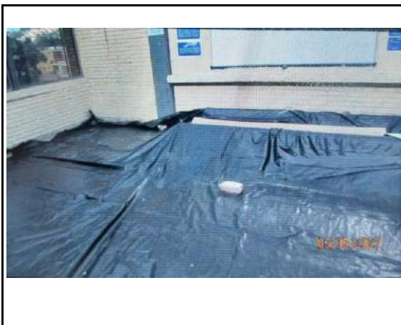
UBICACIÓN: TERCER PISO - BAÑOS COMENTARIOS: PROTECCIÓN CON PLÁSTICO DE LA PLACA A LA INTERPERIE
