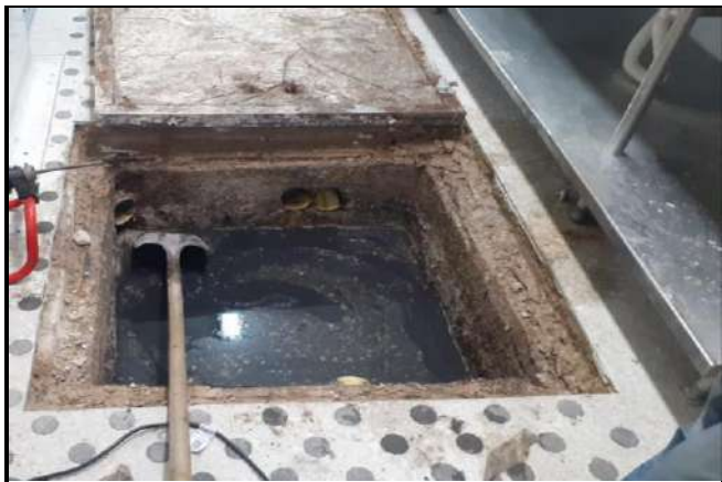
UBICACIÓN: CUCINA COMENTARIOS: CAJA DE INSPECCIÓN
